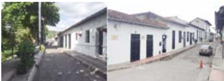
Figura 20. Estado de la pavimentación en la calle 29 y la carrera 30
