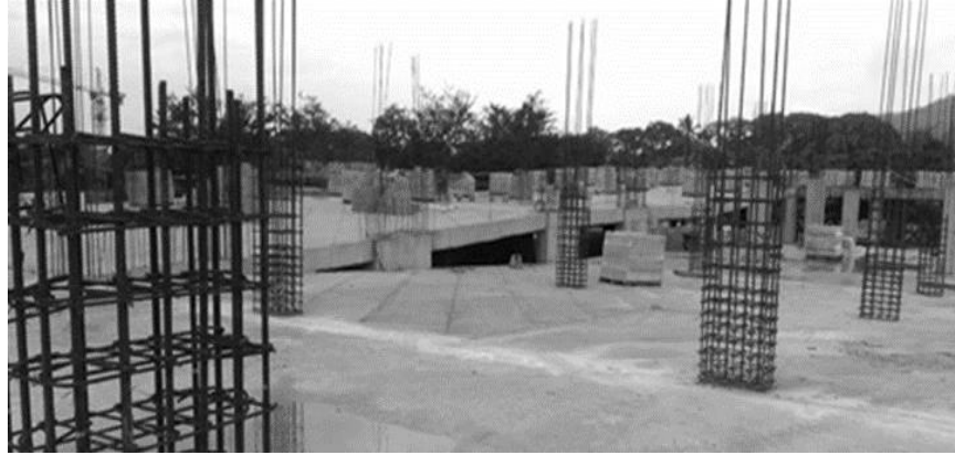
Figura 11: Lesión: Aceros de refuerzo expuesto en columnas. Fuente: Autores.
