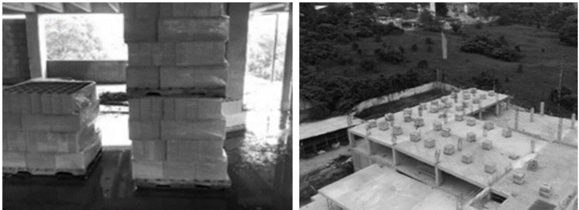
Figura 12: Lesión: Sobre carga den el edificio de parqueadero. Fuente: Autores.
