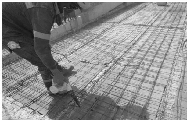
Figura 51: Procedimiento para el trato de la lesión en el edificio de parqueadero. Fuente: Los autores
