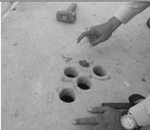
Figura 31: Procedimiento de roció de la fenolftaleína en la placa de contrapiso del parqueadero. Fuente: Los autores
