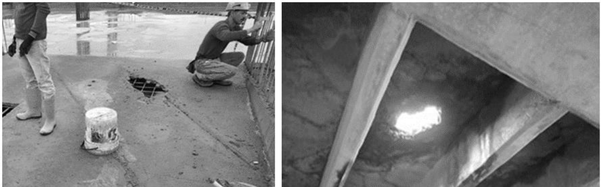
Figura 10: Lesión: Desprendimiento en la losa de entrepiso del parqueadero. Fuente: Autores.
