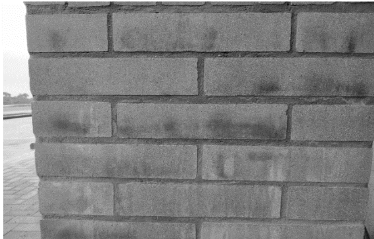
Figura 17: Lesión: Moho y manchas en el ladrillo de fachada. Fuente: Autores.
