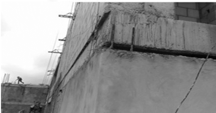
Figura 14: Lesión: Falta de continuidad en vigas. Fuente: Autores.
