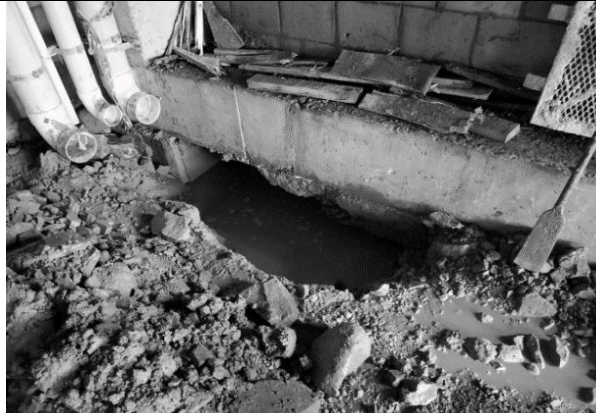
Figura 402: Socavación en una viga de cimentación. Fuente: Los autores
