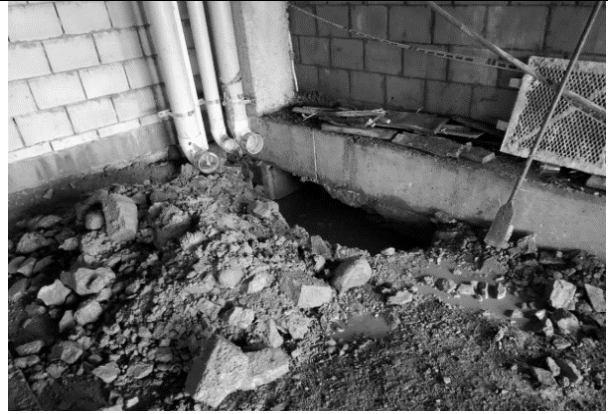
Figura 413: Socavación en una viga de cimentación. Fuente: Los autores
