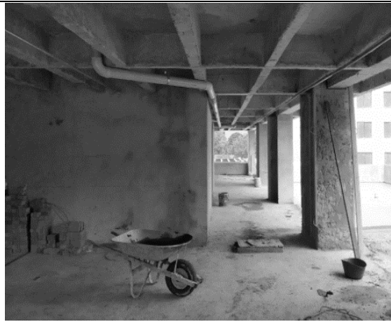
Figura 27: Lugar de extracción en el edificio Club House. Fuente: Los autores
