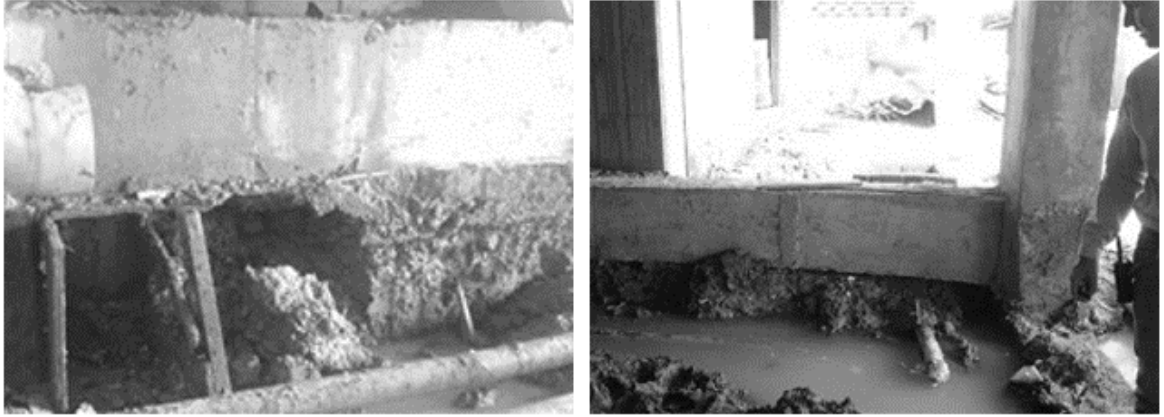
Figura 13: Lesión: Viga de cimentación socavada. Fuente: Autores.
