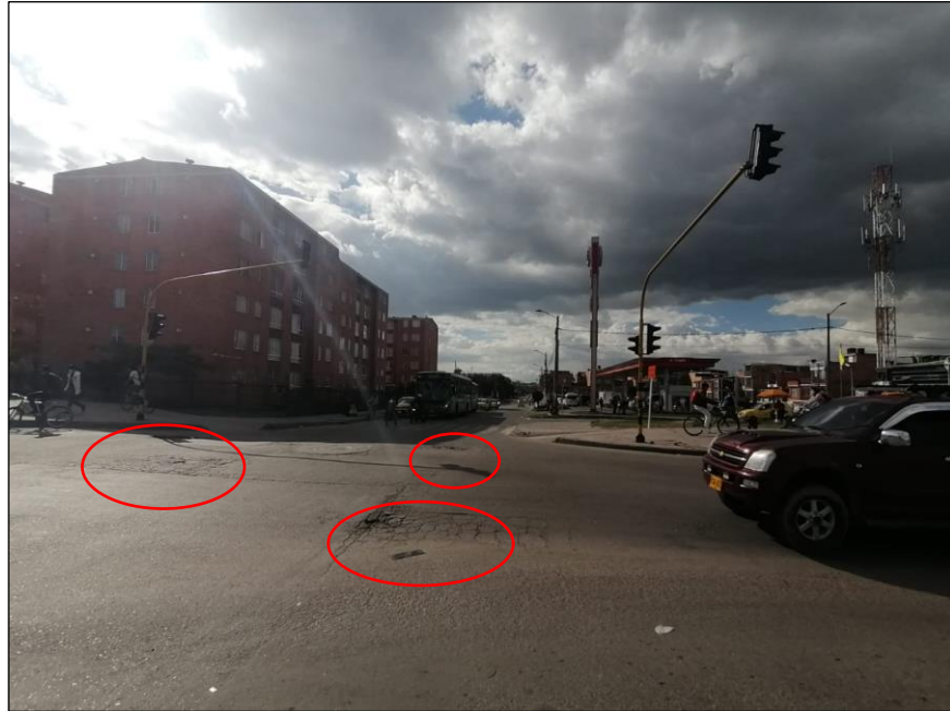
Figura 46. Daños en la infraestructura - Av. Ciudad de Cali con Calle 53 Sur.
