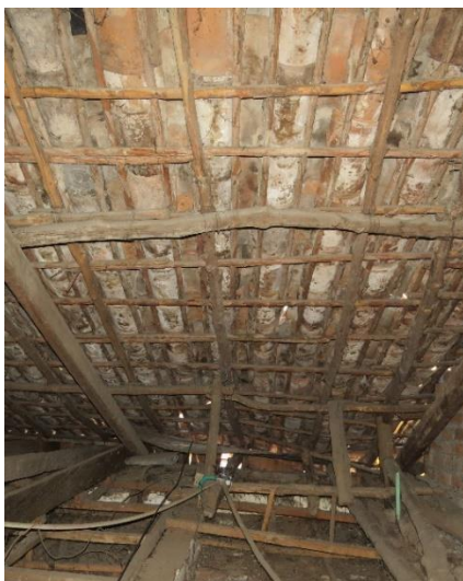
Ilustración 21. Pudrición blanca de estructura de soporte de teja. Fuente propia
