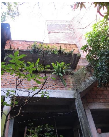
Ilustración 23. Fachada posterior con lesiones de tipo biológico. Fuente. Propia
