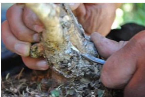
Ilustración 40. Ensayo con gubia en alfardas y correas de la cubierta. Fuente propia
