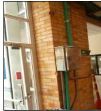
Figura 31. Cables eléctricos y de datos.
