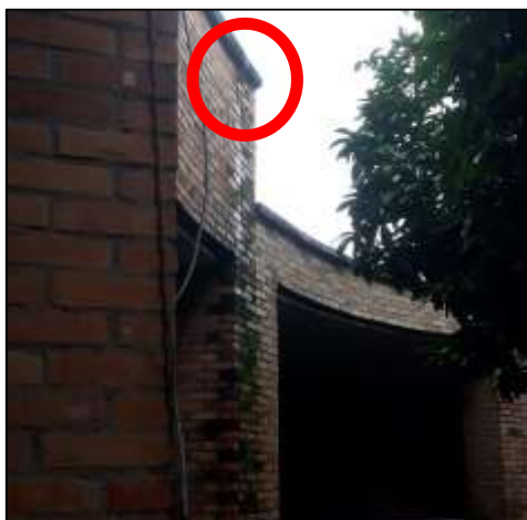
Figura 71. Infiltración en elemento cuatro.
