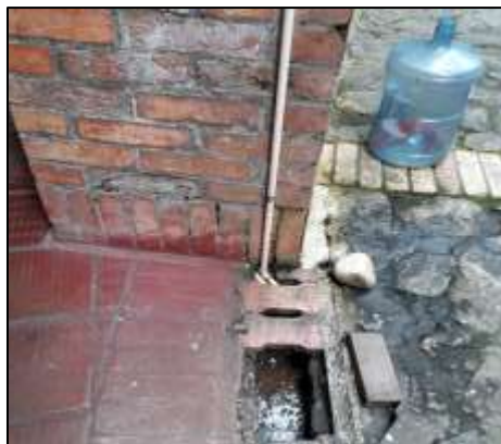
Figura 53. Eflorescencias en ladrillo.
