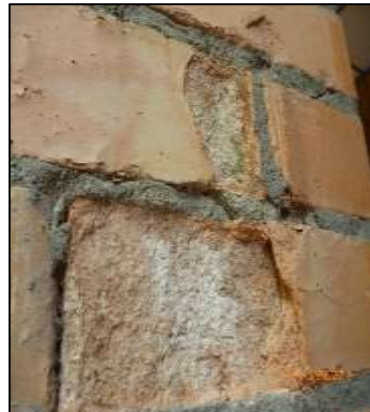
Figura 62. Cripto y eflorescencias.
