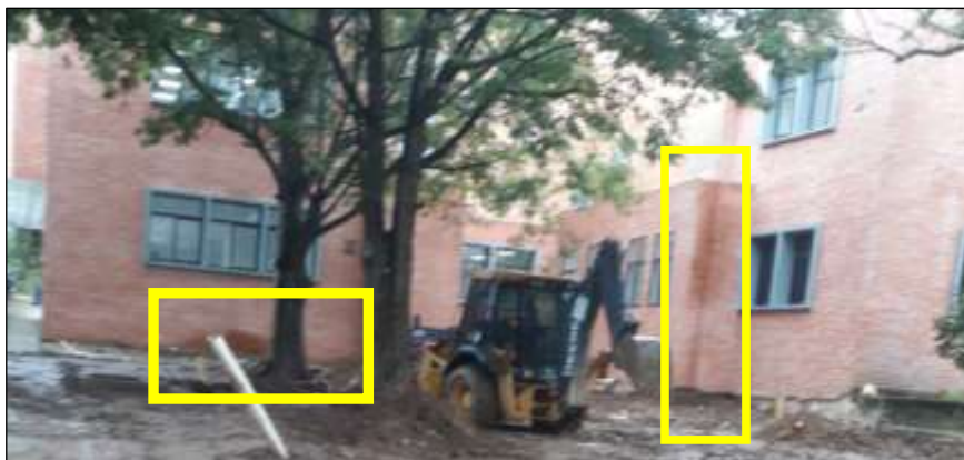
Figura 11. Fuente: autores, (agosto de 2018). Humedad en construcción de área nueva edificio Alcaldía de Yopal.
