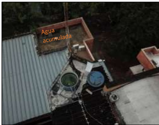
Figura 82. Agua acumulada en placa.
