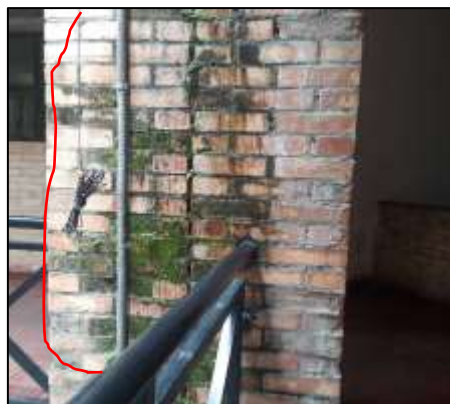
Figura 54. Eflorescencias y humedades.
