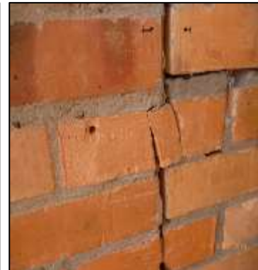
Figura 43. Grieta que rompe ladrillo.
