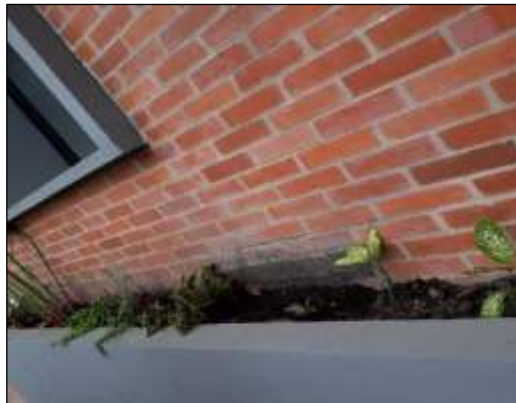
Figura 10. Salpicadura en el ladrillo a la vista.
