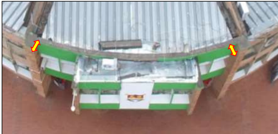
Figura 17. Fuente: autores, (julio 13 de 2018). Las flechas indican la parte que sobresale del alineamiento de las columnas y que en sitio se evidencia que es en ladrillo, esta parte es la que presenta agrietamiento en los dos elementos, Alcaldía municipal de Yopal.
