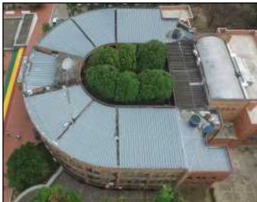
Figura 45. Estado actual de la cubierta.
