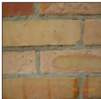
Figura 33. Pérdida capa protectora.
