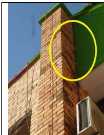
Figura 18. Lugar que presenta desprendimiento de la columna.
