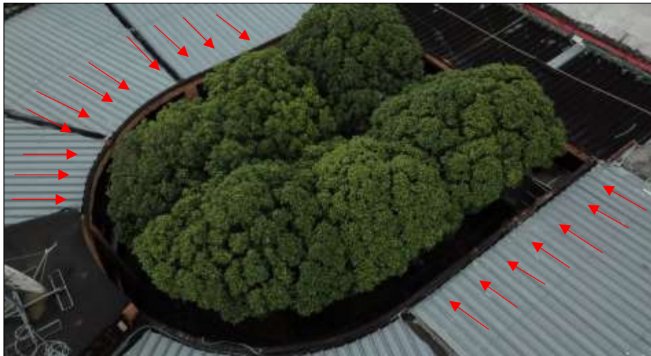
Figura 72. Fuentes: autores, (julio de 2018), Cubierta actual que dirige el agua hacia la mampostería ubicada en la parte interna de la Alcaldía Yopal.
