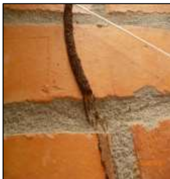
Figura 28. Comején en columna.
