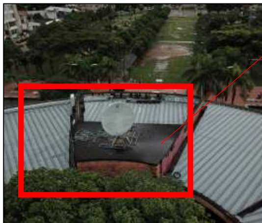
Figura 68. Placa que almacena agua lluvia.
