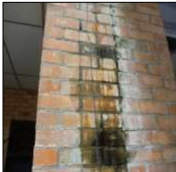
Figura 32. Humedad en columna.
