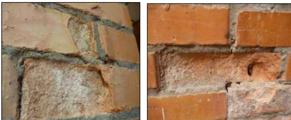
Figura 55. Ladrillo afectado por criptoeflorescencias. Figura 56. Ladrillo afectado por criptoeflorescencias. Figuras 55, 56. Fuente: autores, (enero 2018). Ladrillo de revestimiento afectado por cripto eflorescencias, columnas internas Alcaldía Yopal.
