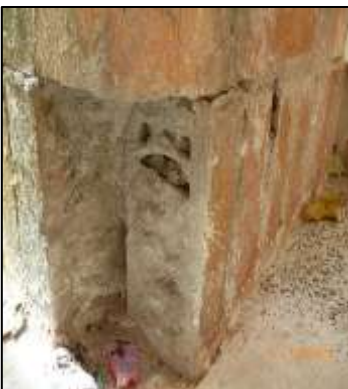
Figura 64. Elemento faltante en columna.
