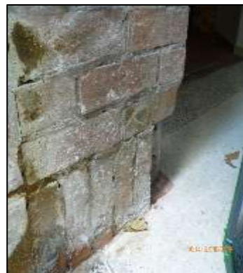
Figura 65. Eflorescencias tipo II.
