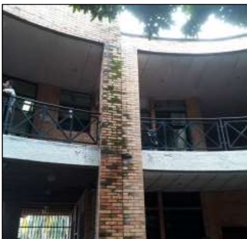
Figura 70. Estado actual ladrillo de revestimiento.
