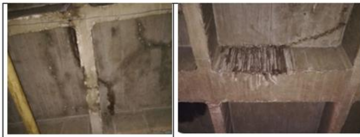
Figura 8. Humedades típicas en losa de entrepiso. Fuente: Elaboración propia.
