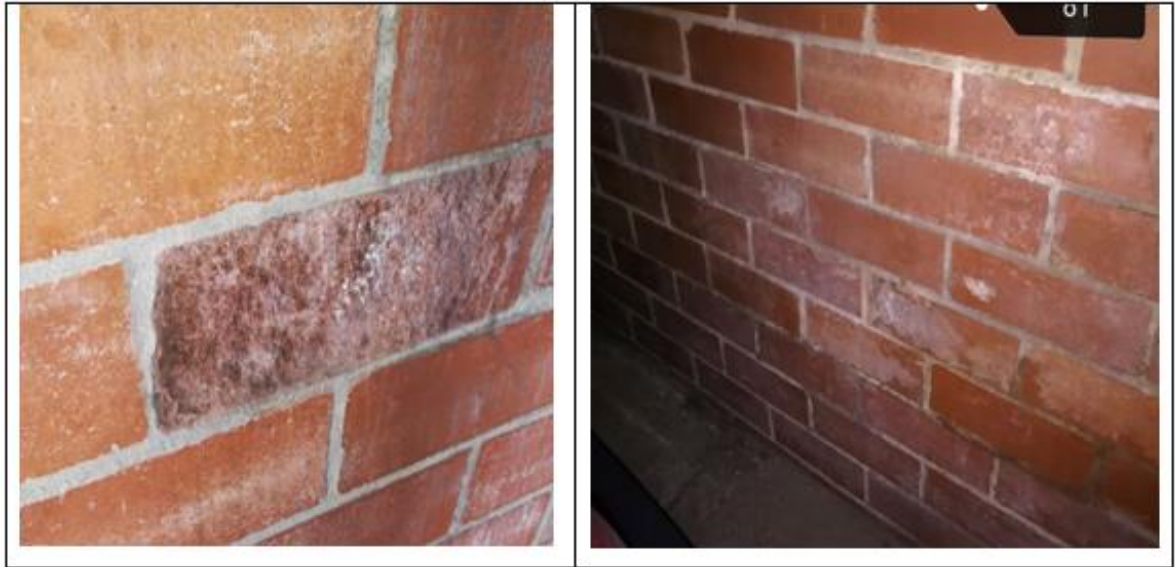
Figura 11. Erosiones en mampostería. Fuente: Elaboración propia.
