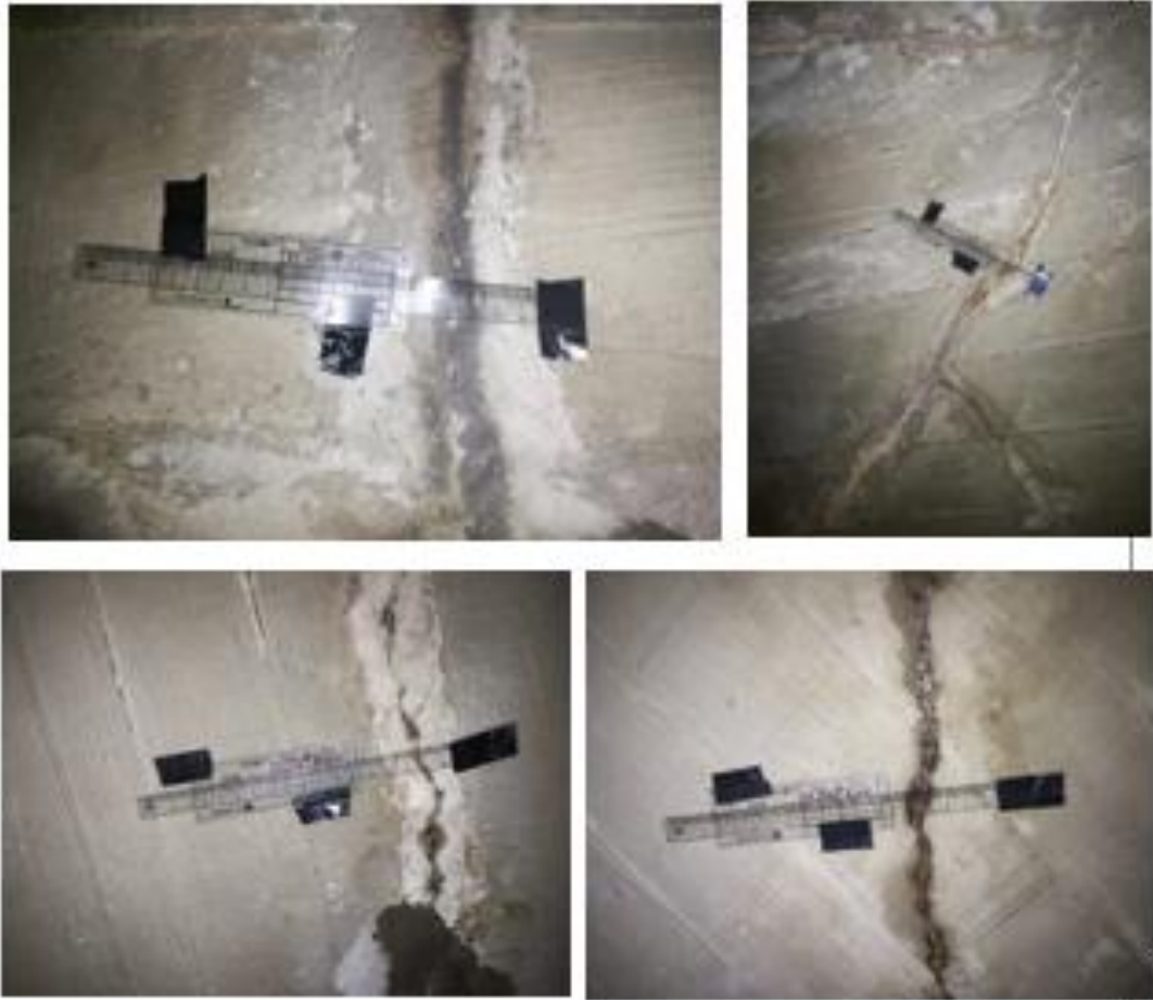
Figura 18. Registro fotográfico de Fisurómetros en placa entrepiso. Fuente: elaboración propia.
