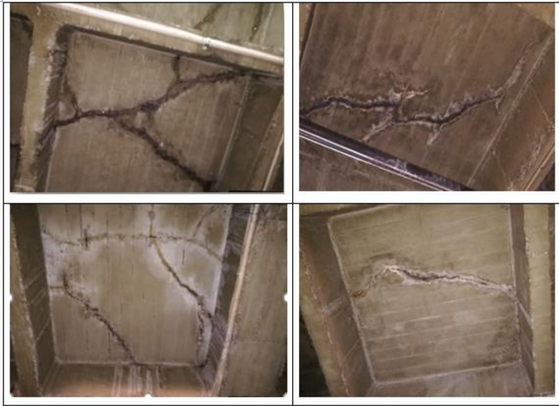
Figura 10. Grietas y fisuras típicas en placa de entrepiso. fuente: Elaboración propia.
