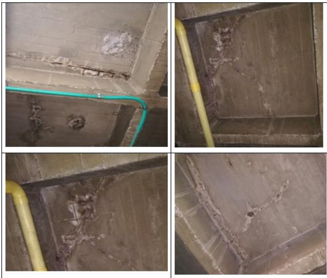
Figura 13. Corrosión o carbonatación en los aceros de refuerzo de la placa. Fuente: elaboración propia.
