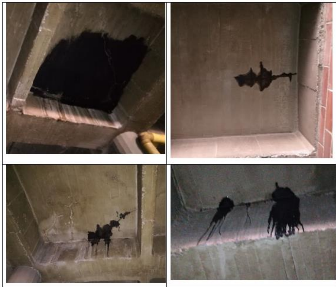
Figura 12. Filtraciones de emulsión asfáltica. Fuente: elaboración propia.
