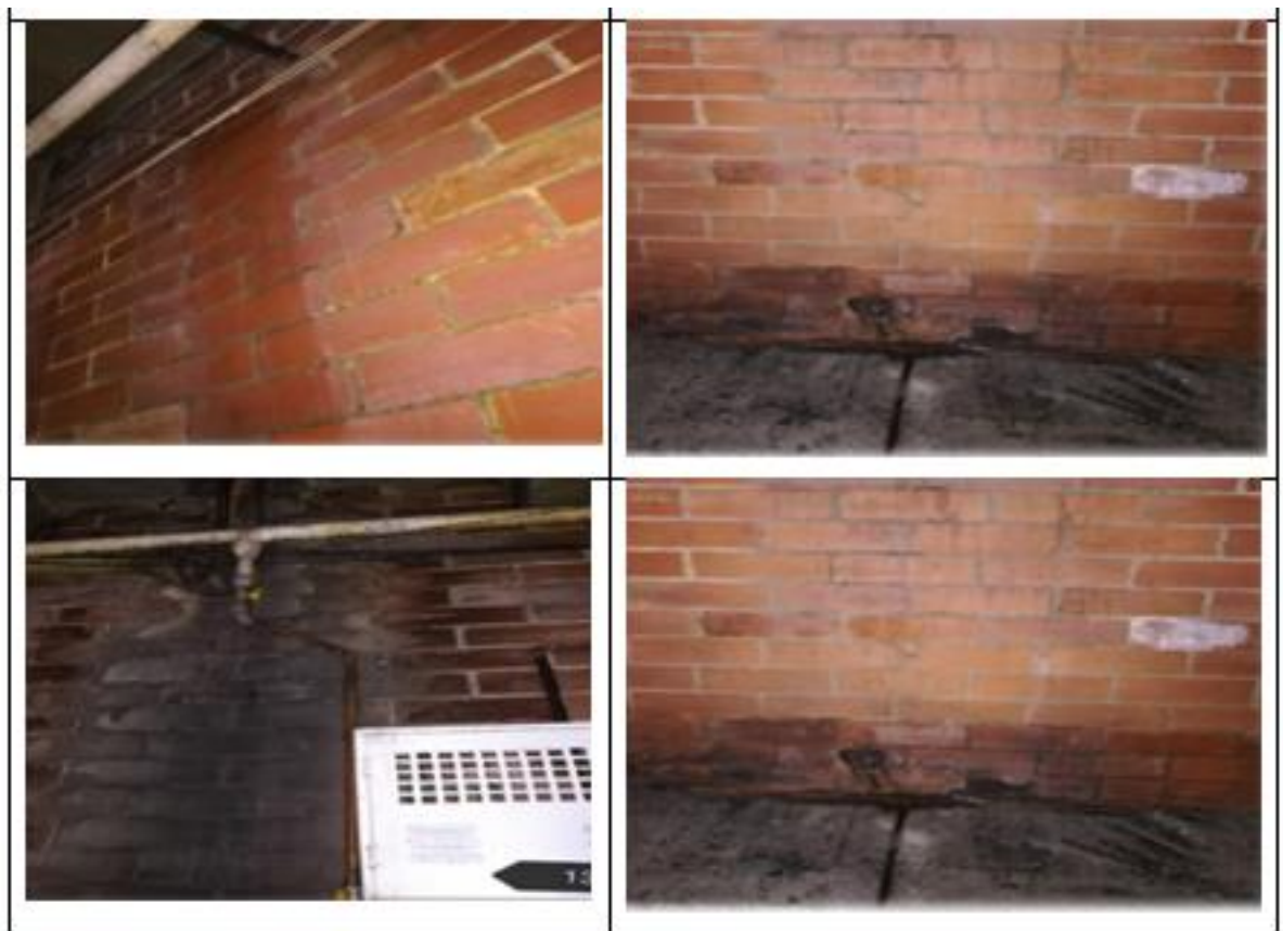
Figura 9. Humedades típicas en muros de mampostería. Fuente: Elaboración propia.
