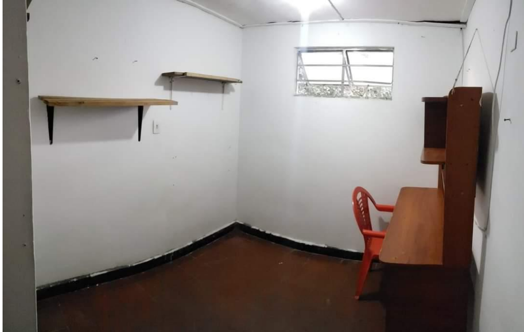
Figura 1. Habitación en arriendo con escasa ventilación e iluminación, sector UIS
