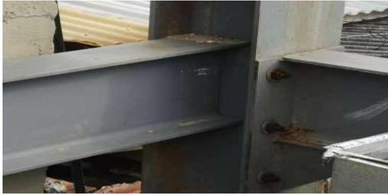
Figura 10. Cambios en la estructura
