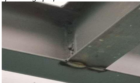
Figura 2. Soldadura no uniforme Viga perforada
