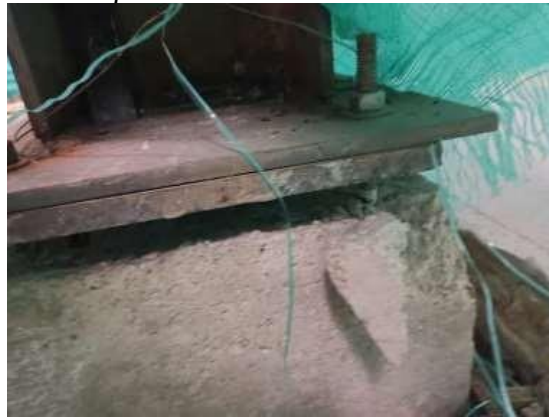
Figura 17. Fractura de vértices de pedestales en concreto.
