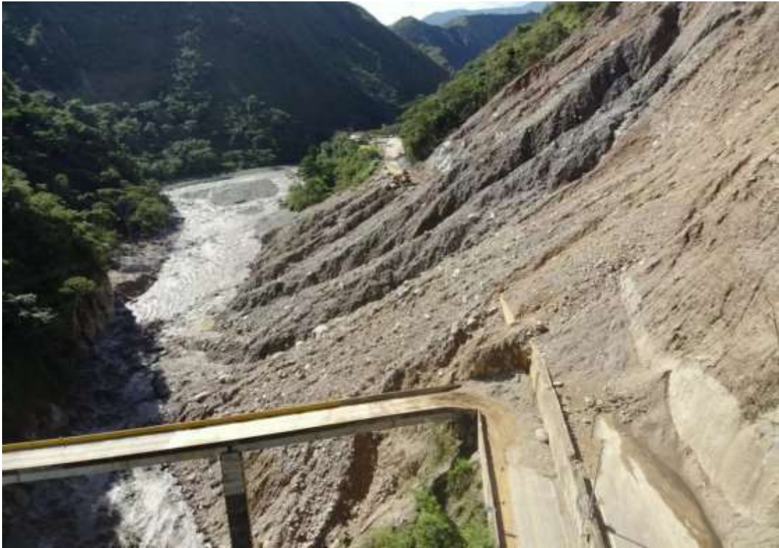
Figura 61. Talud del Kilometro 58 de la via Bogota – Villavicencio en el año 2019. [6]
