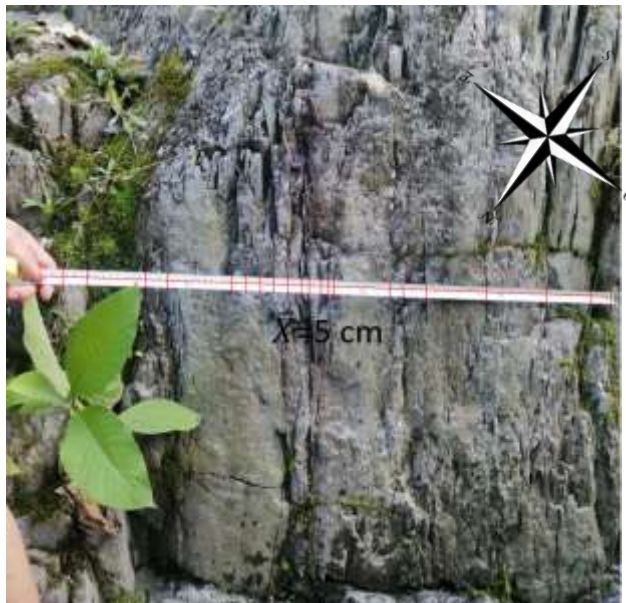
Figura 18. Fractura vertical del macizo rocoso de la quebrada Perdices. Fuente: Propia.
