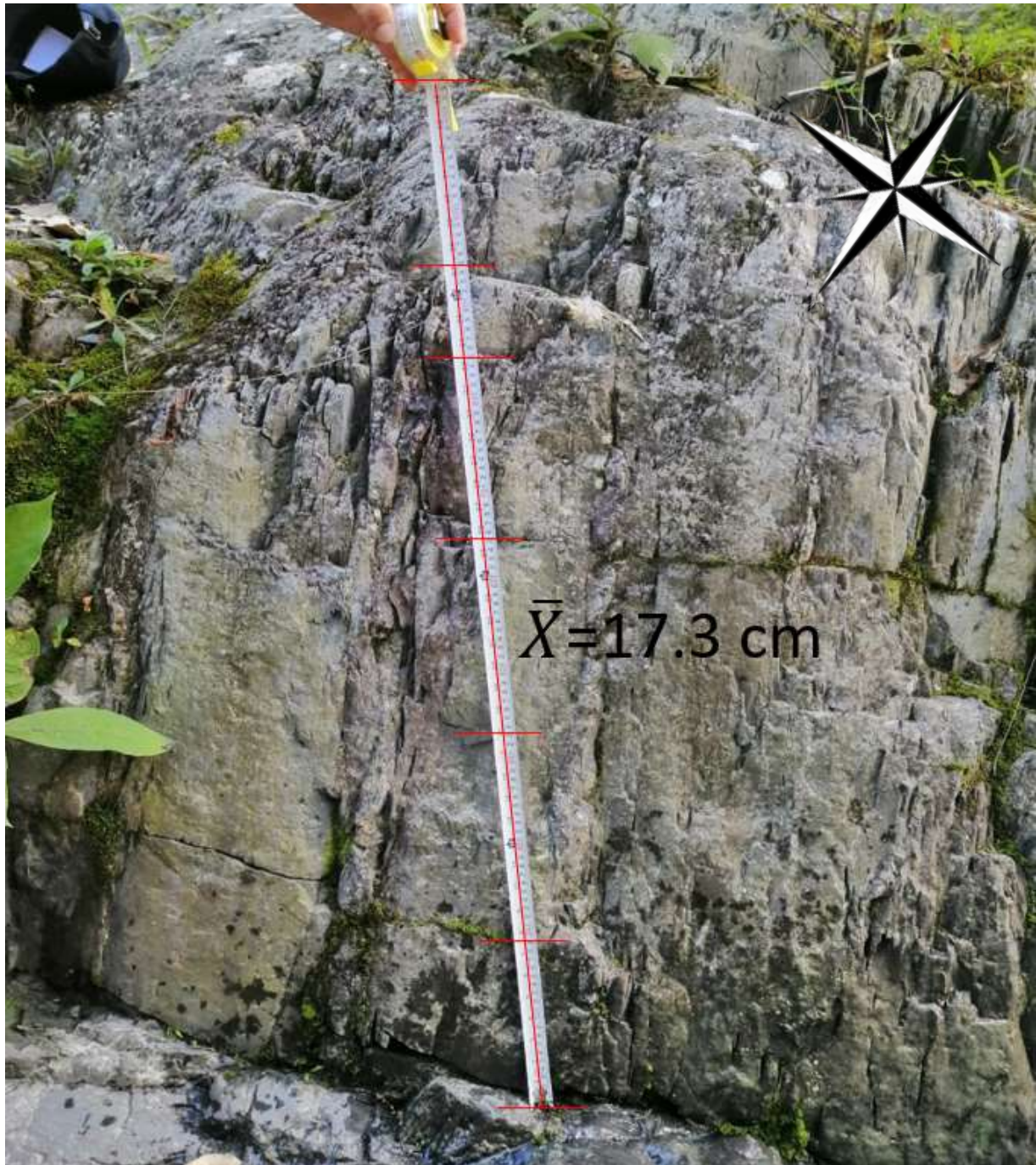
Figura 17. Fractura horizontal del macizo rocoso de la quebrada Perdices. Fuente: Propia.
