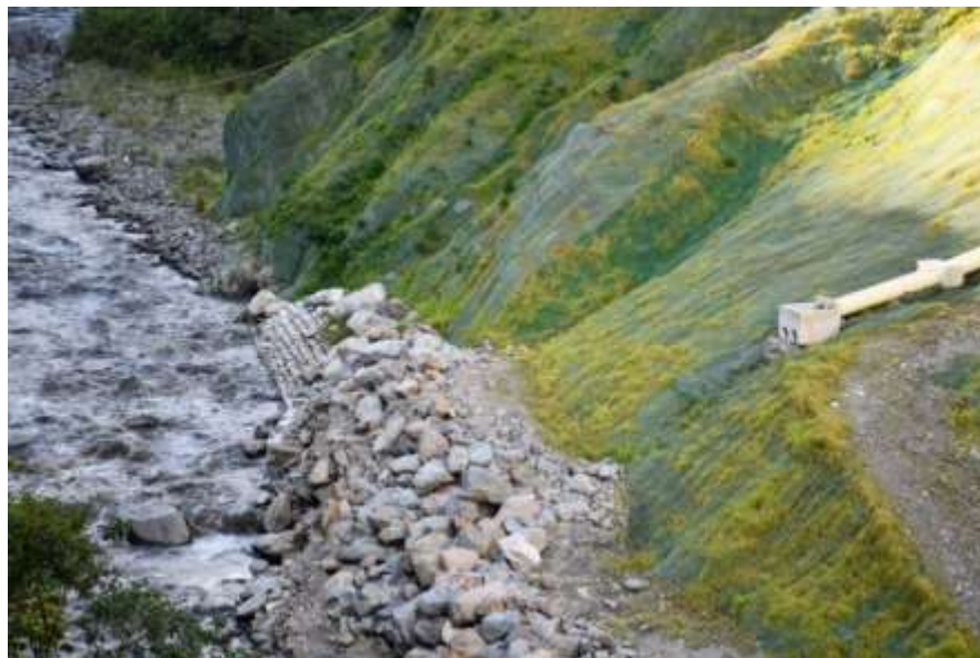
Figura 63. Talud del Kilometro 58 de la via Bogota – Villavicencio en el año 2020. Fuente: Propia.
