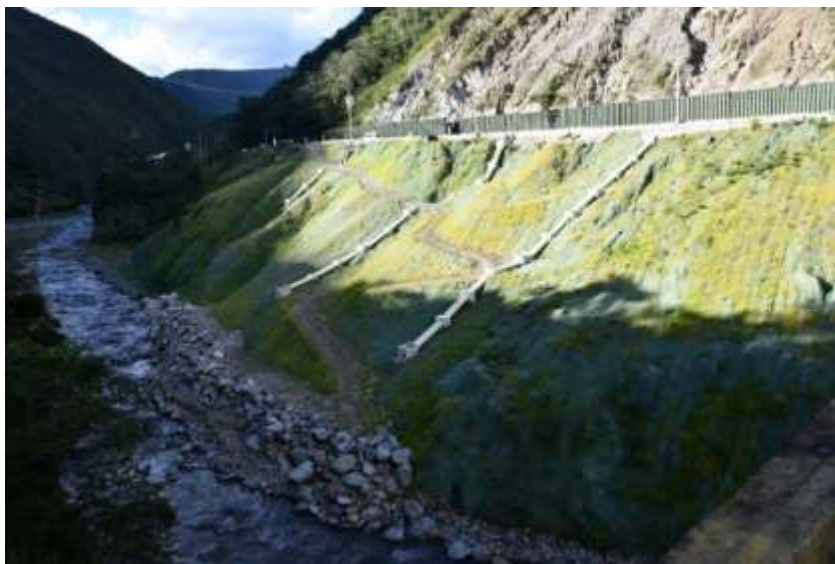
Figura 62. Talud del Kilometro 58 de la via Bogota – Villavicencio en el año 2020. Fuente: Propia
