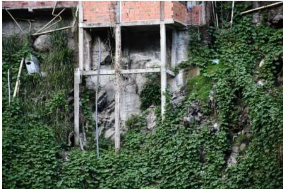
Figura 81. Estado de las estructuras de las viviendas de la parte baja de barrio Nuevo.
