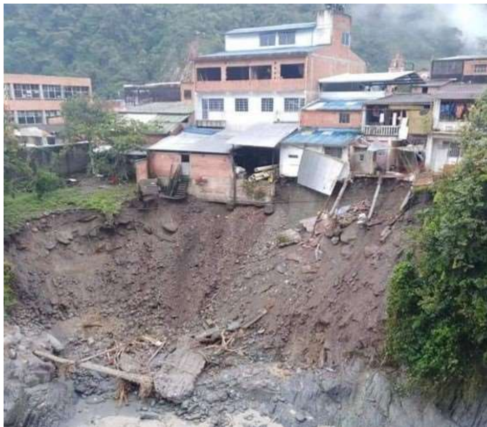
Figura 2. Inestabilidad del talud en el margen derecho de la quebrada Perdices (año 2019) [6].
