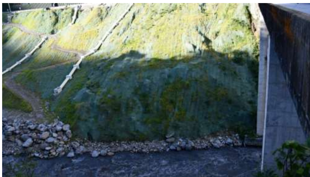
Figura 64. Talud del Kilometro 58 de la via Bogota – Villavicencio en el año 2020. Fuente: Propia
