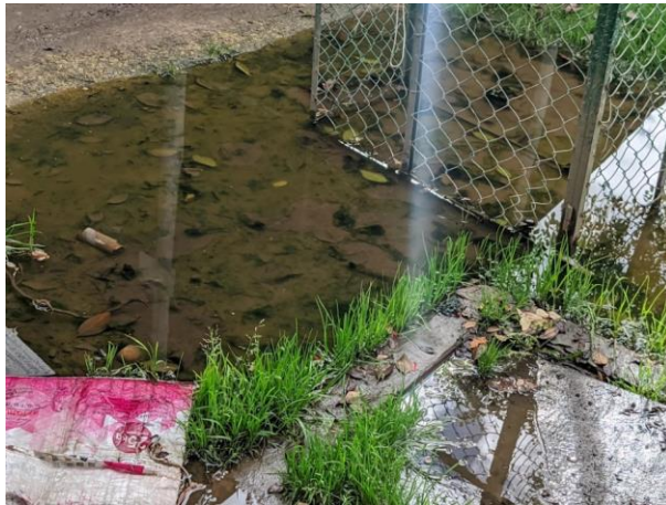
Figura 11 Estado actual del pozo séptico.
