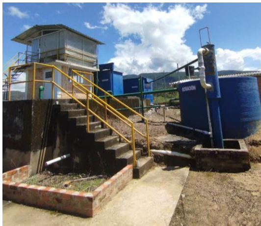
Figura 20 Visita inspección PTAP Hatillo sector Mirto, Tortur, Chacami y Waterloo Fuente: Autor,2023
