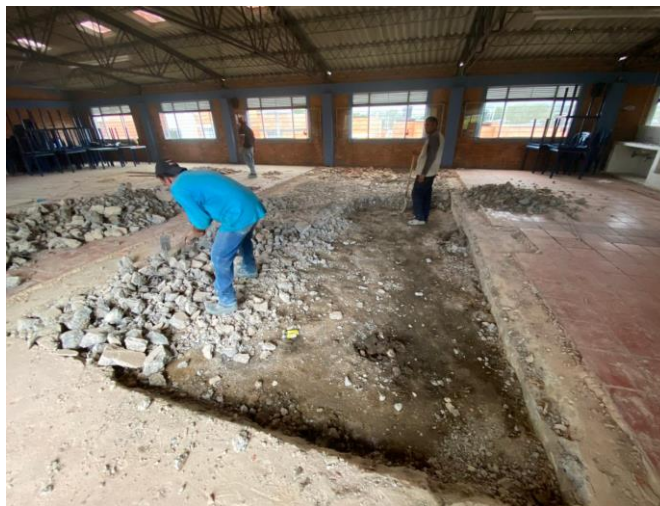
Figura 11 Visita supervisión demolición piso en tableta I.E Haydee Camacho Saavedra Fuente: Autor,2023
