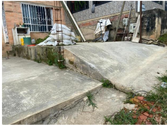
Figura 25 Vista inspección ocular obstaculización peatonal vivienda Fuente: Autor,2023
