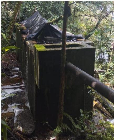
Figura 16 Visita inspección desarenador acueducto vereda centro y parte de carare Fuente: Autor,2023
