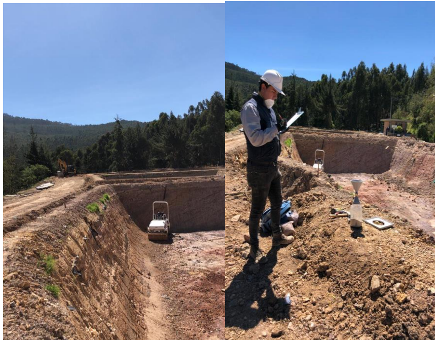
Ilustración 27. Piscinas de lixiviados relleno sanitario.
