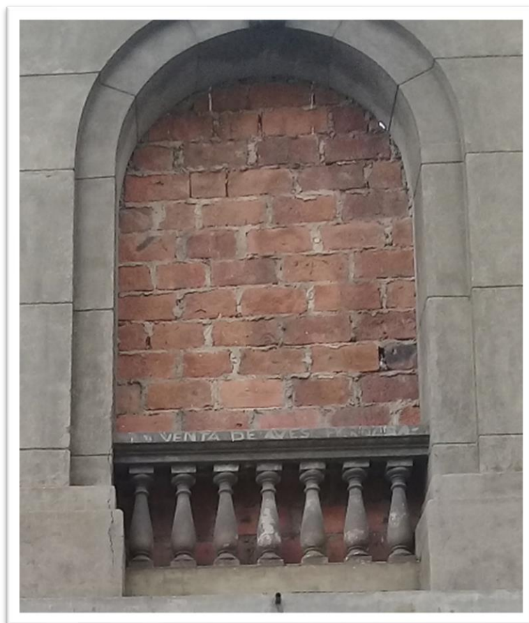
Figura 70. Sellamiento de vanos en fachada.
