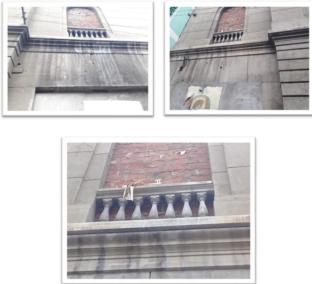
Figura 66. Humedades presentes en fachada. Fuente:
