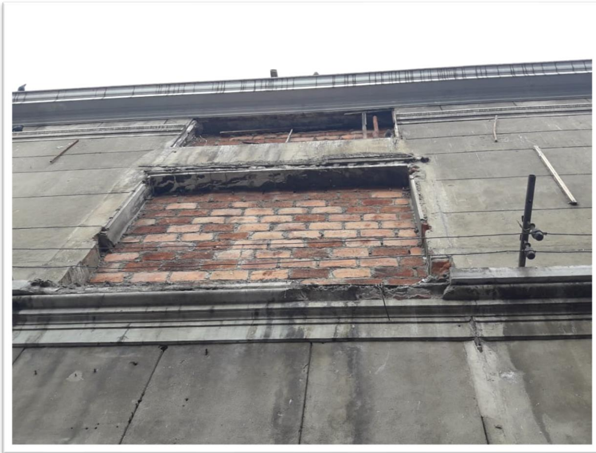
Figura 71. Alteración de vanos originales.
