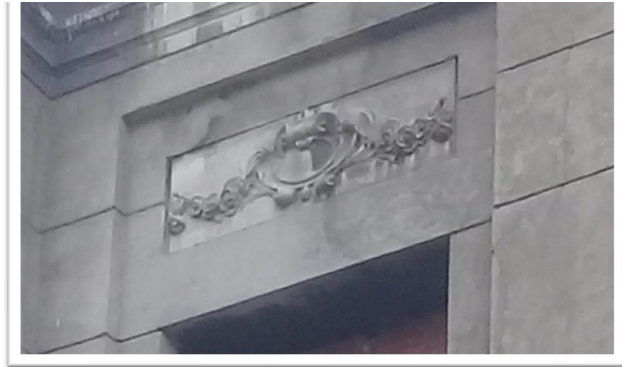
Figura 68. Deterioro por evacuación de aguas lluvias. Fuente: Elaboración propia
