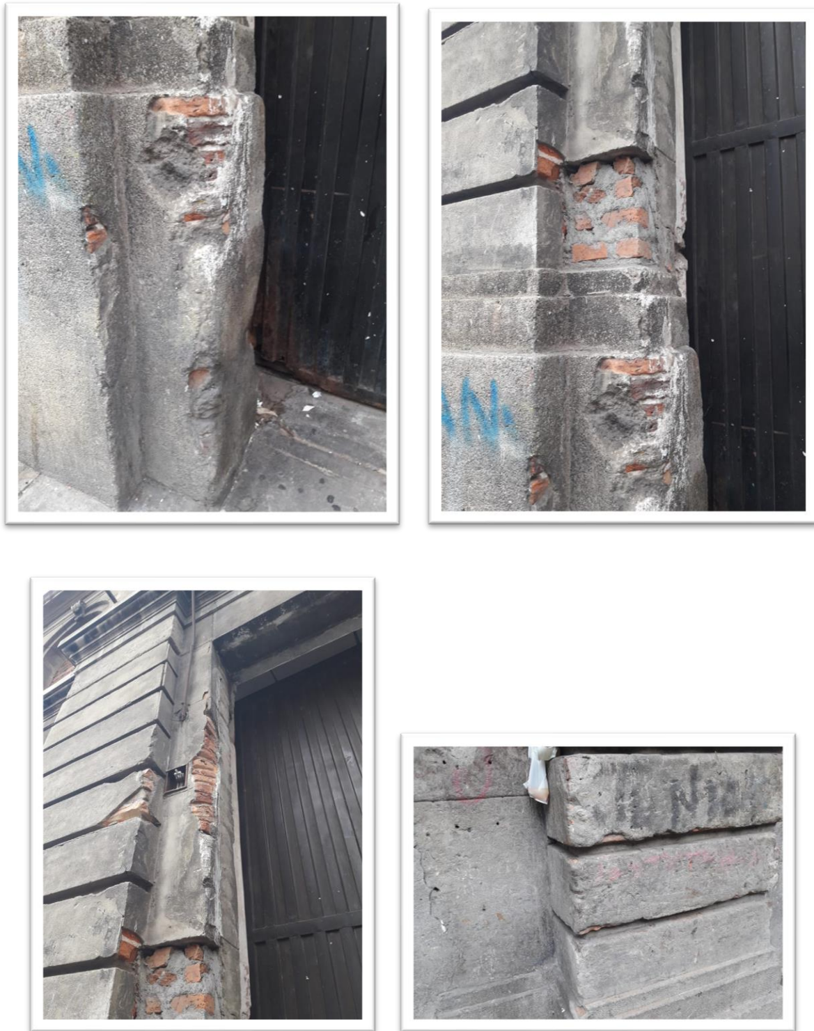
Figura 72. Desprendimiento de revoques.
