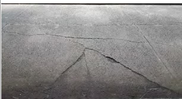
Imagen No. 10IT. Se evidencia un hundimiento hacia el borde izquierdo de la placa.
