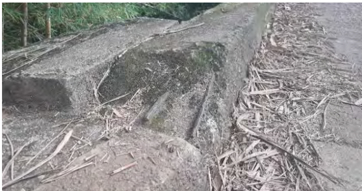
Imagen No. 150733. Desportillamiento y Acero expuesto. Bordillo derecho, salida del puente.
