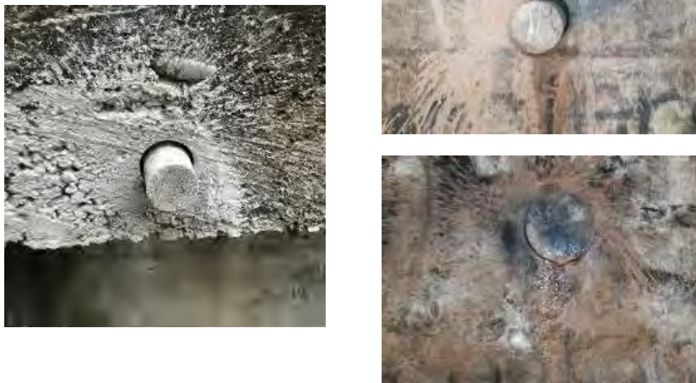
Figura 24. Detalles de núcleos extraídos de los elementos de vigas y placas.
