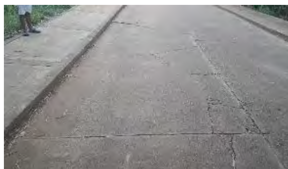
Zona de aproximación costado sur del puente. Sobre las placas izquierdas de la vía se presentan lesiones por agrietamiento en el sentido longitudinal a la vía y hundimiento de estas.
