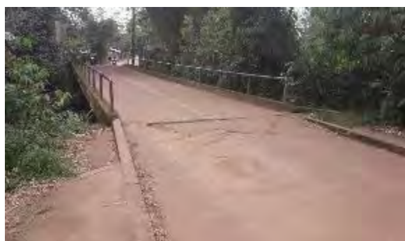
Zona de aproximación costado sur del puente. Las placas que rematan en el puente presentan hundimiento y se encuentran fisuradas en sentido longitudinal y transversal al eje de la vía. No hay junta de expansión entre las placas y el puente.
