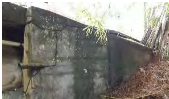
Aleta nororiental. No se evidencia presencia de fisuras. Tiene presencia de lesiones por suciedades y presencia de musgos y hongos.
