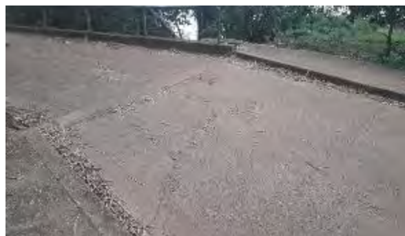
Zona de aproximación costado norte del puente. Las placas que rematan en el puente s encuentran fisuradas en sentido longitudinal y transversal al eje de la vía. No hay junta de expansión entre las placas y el puente.
