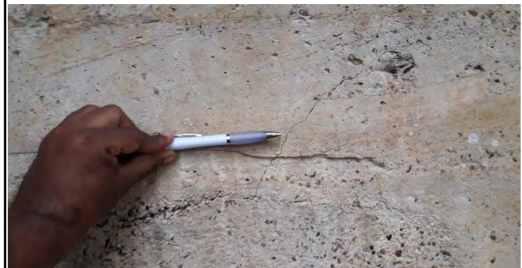
Imagen No. 172233. detalle de la fisura de espesor 1 mm
