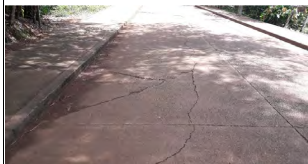
Imagen No. 10IL. Grietas en bloque, longitudinales que se prolongan en placas aledañas. Cercano a la zona de hundimiento de las placas no se evidencia drenaje.
