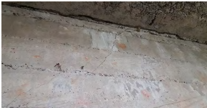
Imagen No. 172156. Detalle de la fisura inclinada, se aprecia en las dos caras laterales de la viga.
