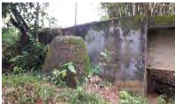
Aleta noroccidental. No se evidencia presencia de fisuras. Tiene presencia de lesiones por suciedades y presencia de musgos y hongos.
