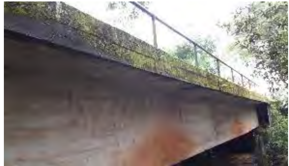
Viga principal occidental, placa y baranda. Hay presencia de lesiones de tipo biológico en las paredes de la placa y hormigoneo en algunos sectores de la viga y construcción inadecuada de juntas frías.
