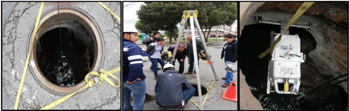
Figura 3 Montaje radar Flodar
