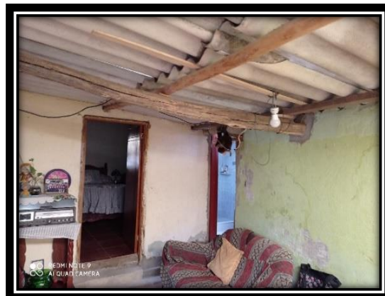
IMAGEN 23. Muros internos vivienda Lida Mogollón
