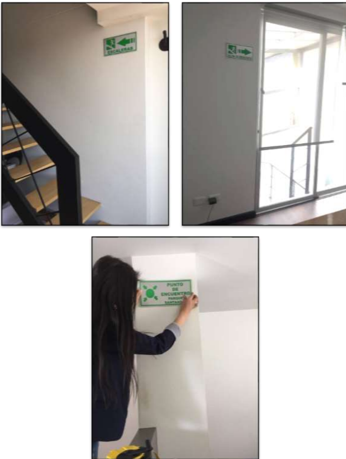
Imagen 1. Instalación de ruta de evacuación. Fuente: Autor
