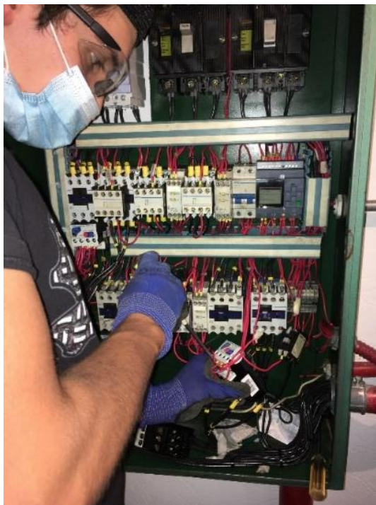
Figura 23. Conexión de relé térmico bajo la guía de técnico especializado
