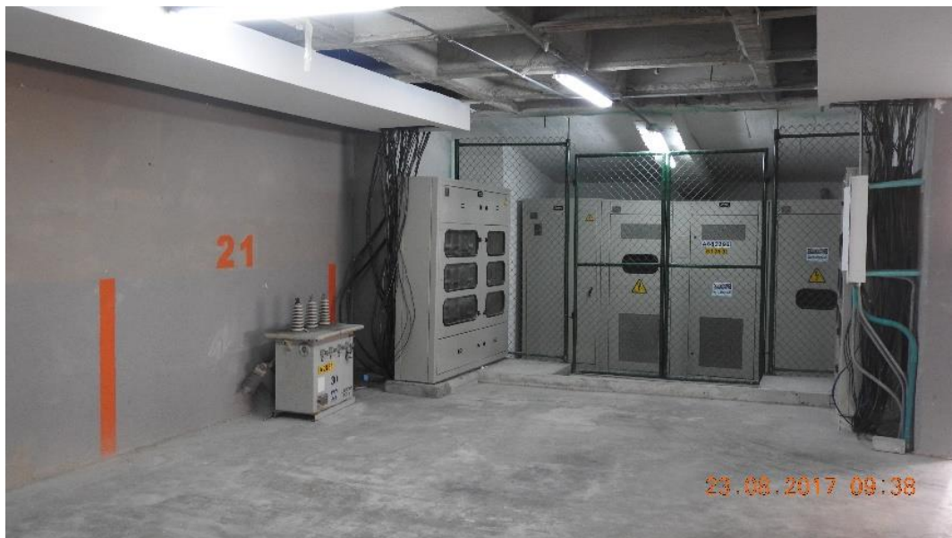
Figura 7. Tableros eléctricos conjunto residencial
