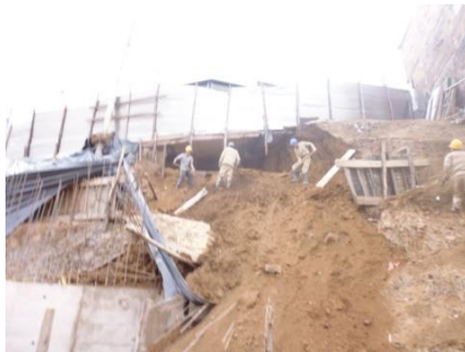
Fotografía 81: Aumento de la socavación de la base de la vía con deslizamiento y destrucción de entibado.
