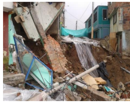
Fotografía 96: Tramo destruido de la CARRERA 10C ESTE.
