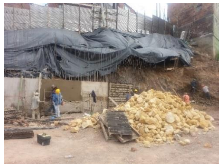
Fotografía 76: Fundición del muro de contención e inestabilidad del talud. Marzo 6 de 2015.
