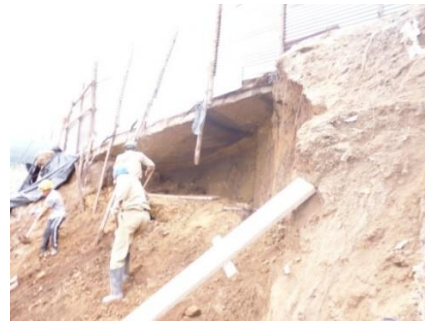
Fotografía 82: Socavación por debajo de las losas de la vía.
