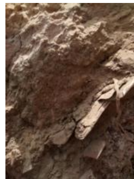
Fotografía 24: Presencia de basura en la base de la vía.
