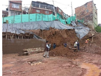
Fotografía 66: Falla del entibado y deslizamiento parcial.
