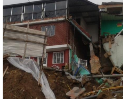
Fotografía 94: Estado y aspecto de la zona después del movimiento de remoción.
