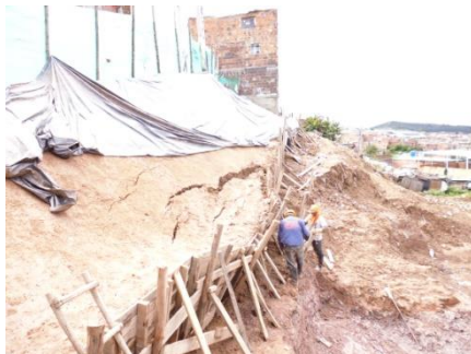
Fotografía 55: Aparición de grietas en el talud.
