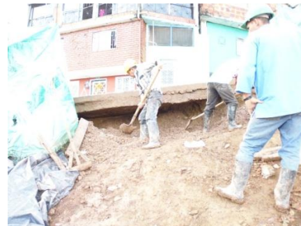
Fotografía 56: Socavación por debajo de las losas de la vía.
