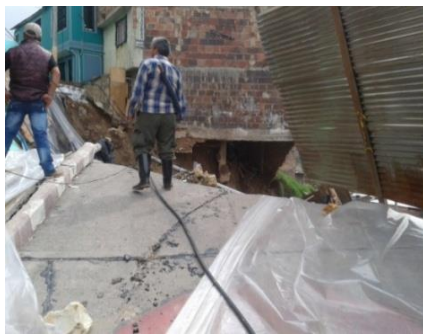
Fotografía 95: Estado y aspecto de la zona después del movimiento de remoción.
