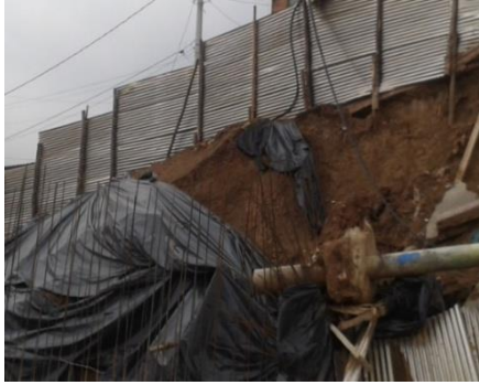
Fotografía 93: Estado y aspecto de la zona después del movimiento de remoción.
