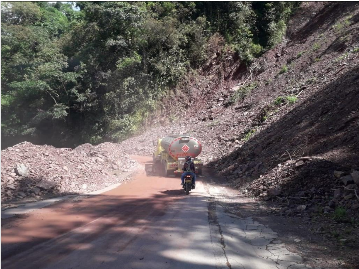
Figura 38. Zona afectada por deslizamiento en vía antigua Bogotá - Villavicencio. Fuente: Elaboración propia.
