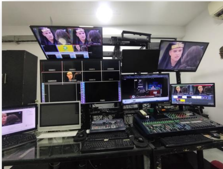
Figura 2. Equipos hardware de Master Control
