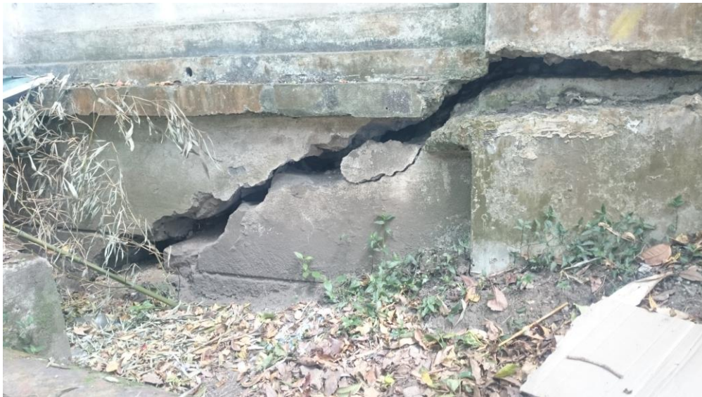
Imagen 1: Grieta que afecta diferentes elementos del puente
