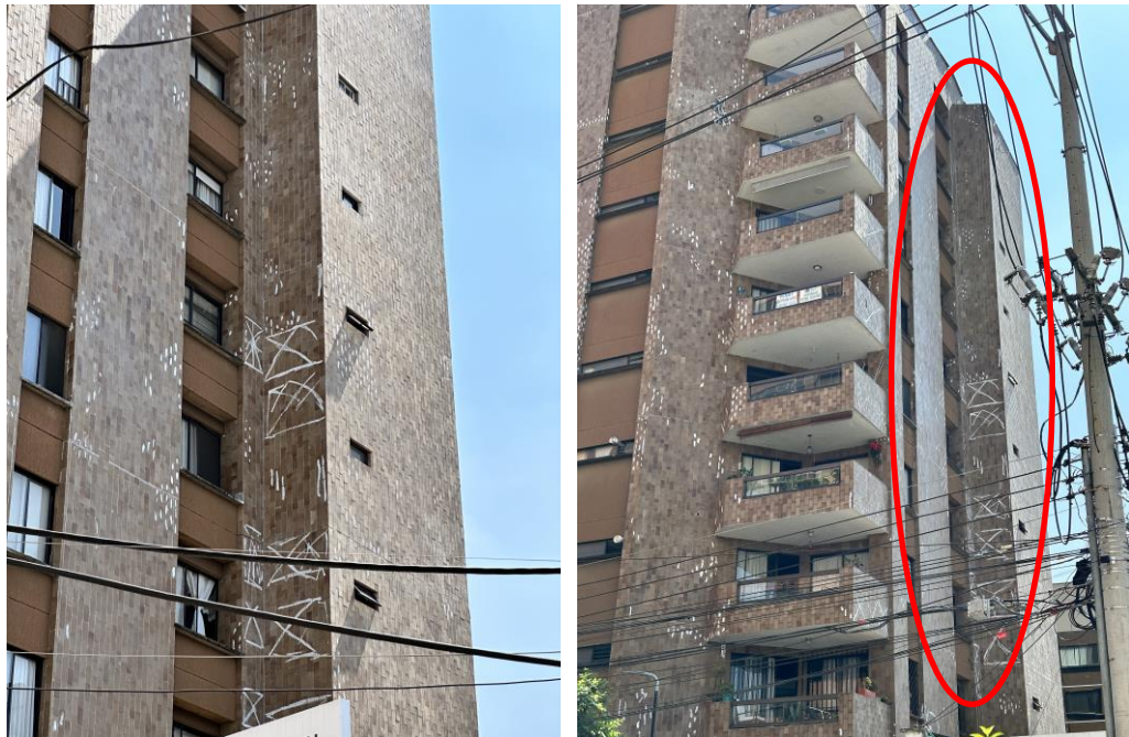
Ilustración 17. Registro fotográfico Humedades. Fuente: propia.
