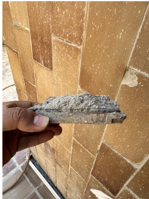
Ilustración 19. Registro fotográfico Mala Ejecución del Proceso Constructivo. Fuente: Propia.
