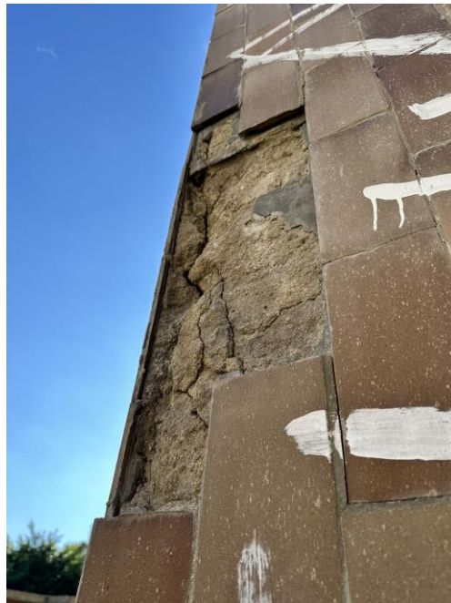
Ilustración 22. Registro fotográfico Fisuramiento por Contracción. Fuente: Propia.
