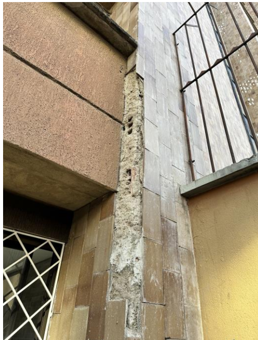
Ilustración 23. Registro fotográfico Desprendimiento de Piezas de Fachada. Fuente: Propia.
