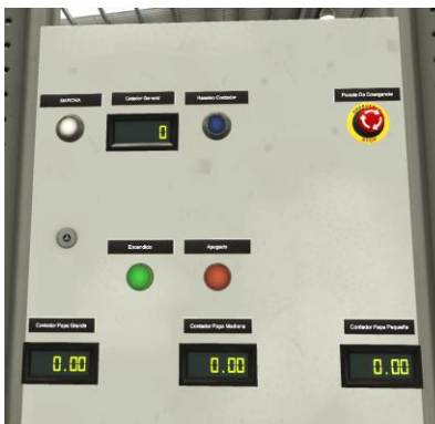
Ilustración 12 Panel de control
