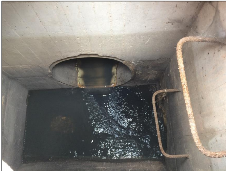
Figura 16. Descarga Zona 1. Alcantarillado combinado existente. (Autor).
