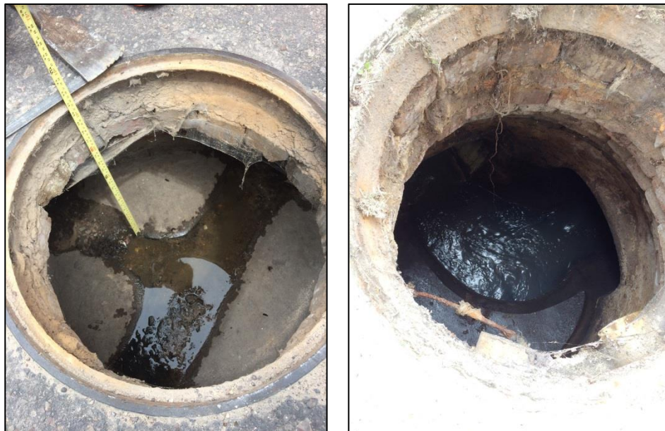
Figura 14. Pozos de inspección Alcantarillado combinado existente. (Autor.)
