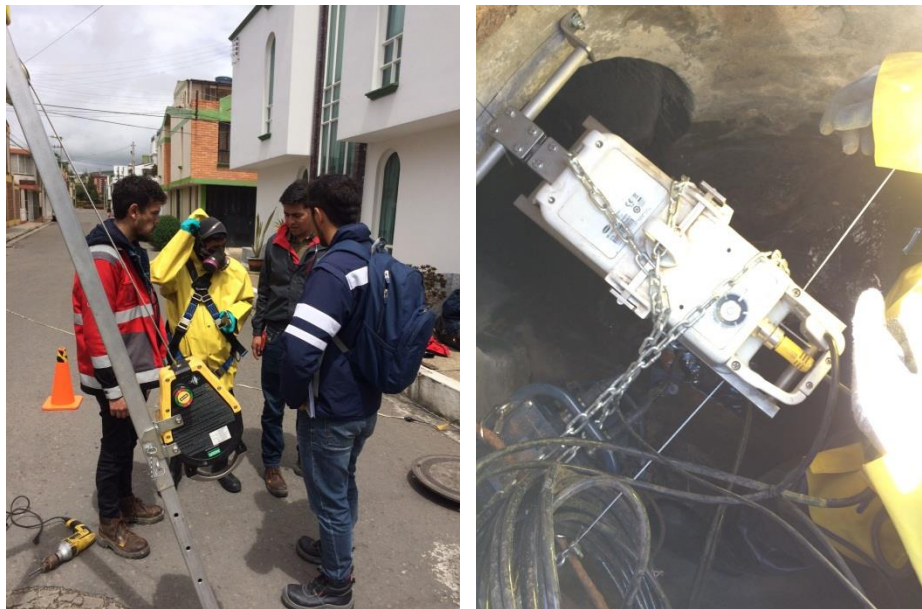
Figura 21. Instalación del sensor Flo Dar - FL900 Series Flow Logger marca Hach. (Autor).
