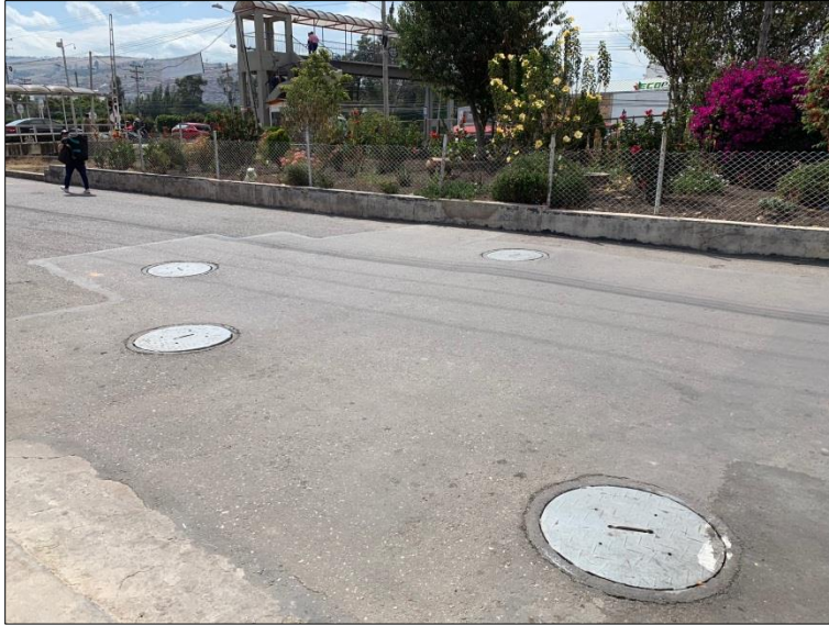
Figura 17. Descarga Zona 2. Alcantarillado combinado existente. (Autor).
