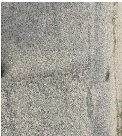
Ilustración 11. Fisura transversal (FT). Fuente: Propia
