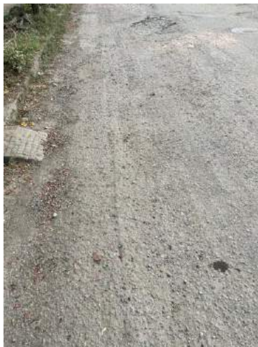
Ilustración 13. Fisura en junta de construcción longitudinal (FCL). Fuente: Propia
