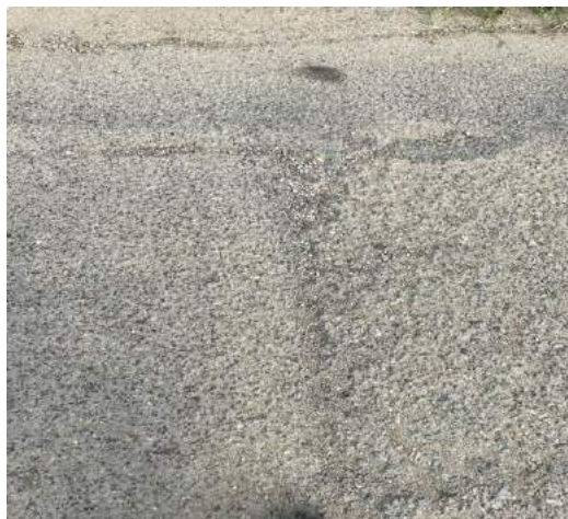
Ilustración 9. Grieta transversal. Fuente: Propia
