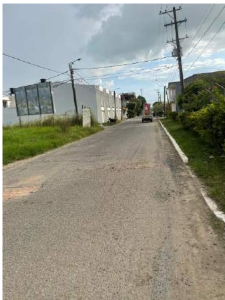
Ilustración 12. Fisura longitudinal (FL). Fuente: Propia
