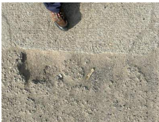
Ilustración 14. Fisura en junta de construcción transversal (FCT). Fuente: Propia
