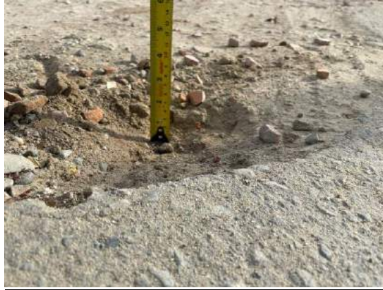
Ilustración 6. Medición de profundidad baches. Fuente: Propia.
