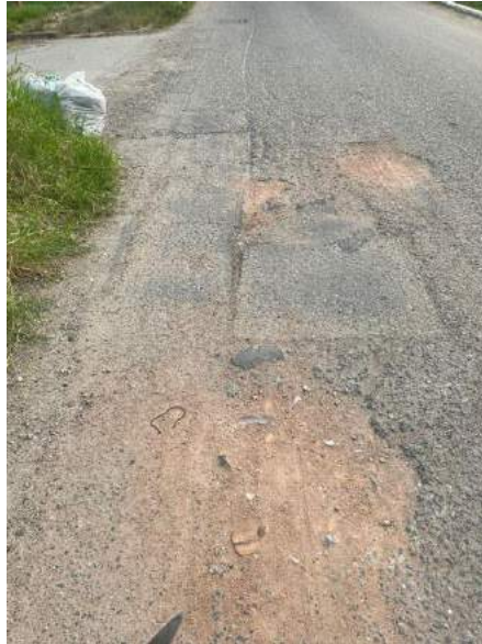
Ilustración 8. Grieta longitudinal. Fuente: Propia
