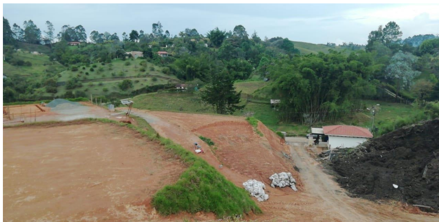
Figura 19. Cortes inadecuados de taludes, para terraceo y explanación para ocupación en vivienda, modalidad de reloteo, Vereda El Salado.
