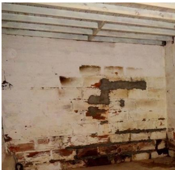
Foto de muro interior del garaje donde se evidencia todo el deterioro en la mampostería.
