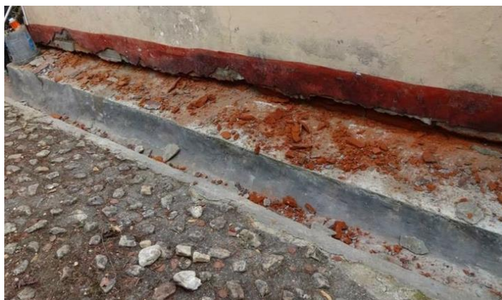
Foto se presenta deterioro en toda la mampostería
