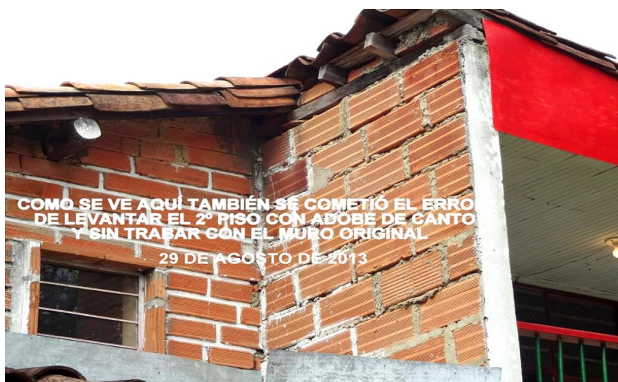
Figura 11. Se muestra cuando se comete el error de levantar el segundo piso con adobe de canto y sin trabar
