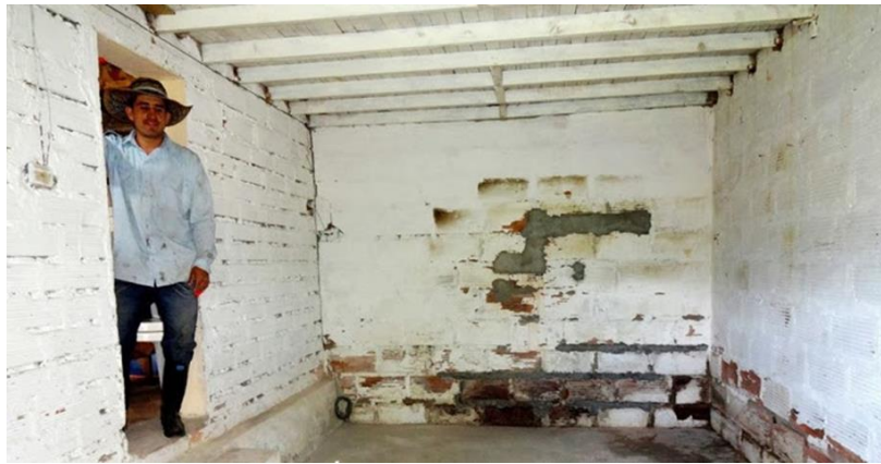
Detalle de muro interior del garaje donde se evidencian diferentes humedades y fisuras en su interior.
