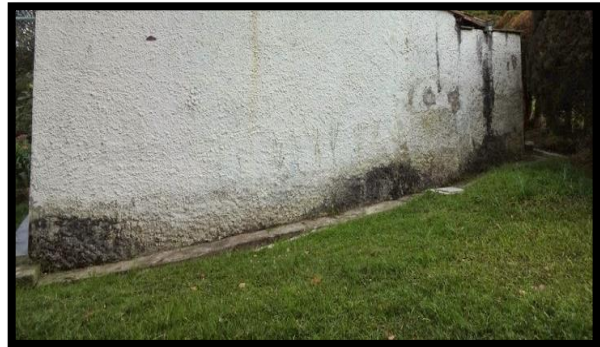
Humedad presentada en la fachada lateral
