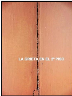
Grieta ubicada en el segundo piso
