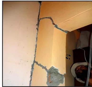
Fisuras presentadas en la estructura
