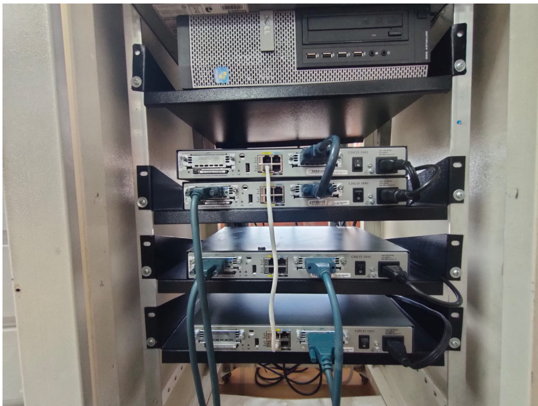
Figura 4.3.4: Routers físicos y cableado de laboratorio para la práctica de enrutamiento estático
