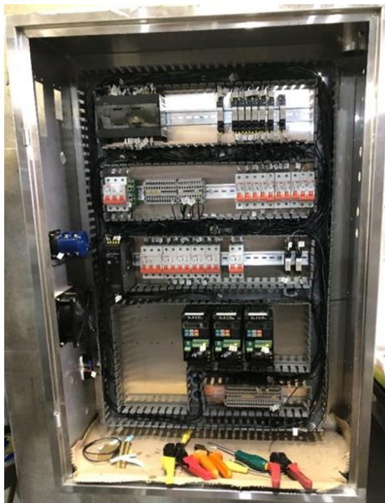
Figura 3. Proceso de Montaje frontal del tablero eléctrico (Fotografía Real).
