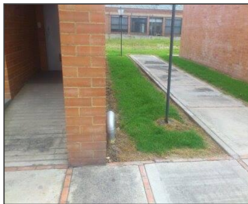
Figura 28. Tubería de ventilación de bóvedas de material fílmico de la Fundación Patrimonio Fílmico Colombiano. Fotografía de los autores.
