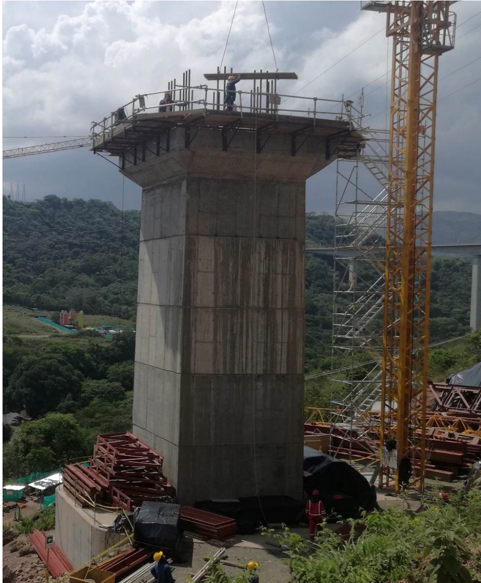
Figura 47: Pila – Capitel Eje 2. Fuente: Constructora Colpatria
