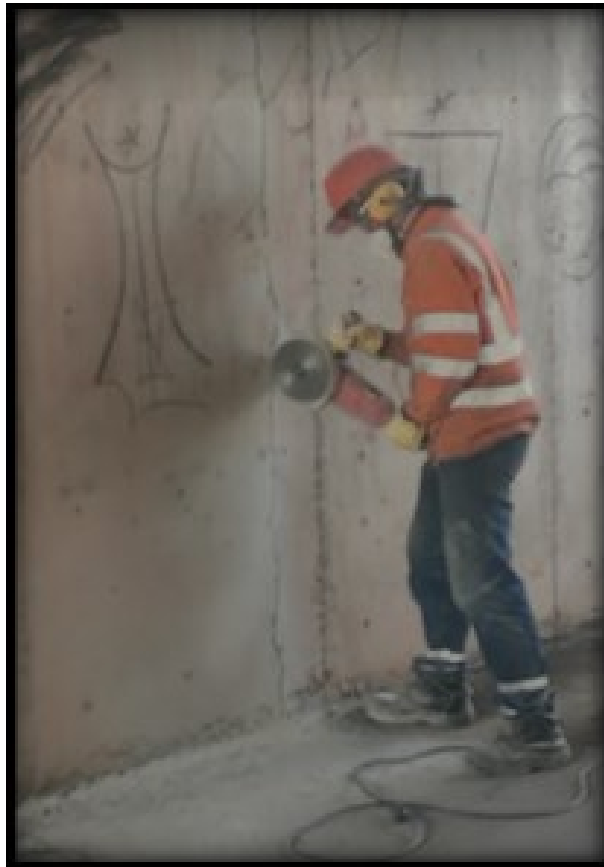
Figura 34: Profundización y ruteo de fisura con cuchilla de diamante. Fuente: Constructora Colpatría
