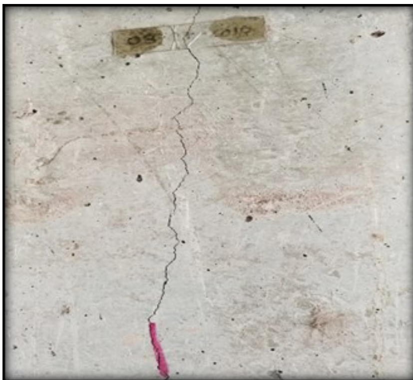
Figura 32: Identificación de fisura activa. Fuente: Constructora Colpatria
