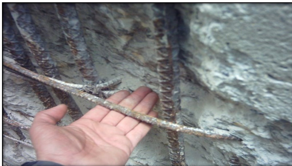
Figura 28: Acero expuesto. Fuente: Constructora Colpatría
