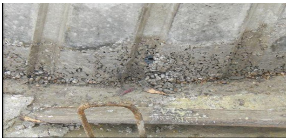
Figura 27: Presencia de hormigueros en estructuras de concreto. Fuente: Constructora Colpatria
