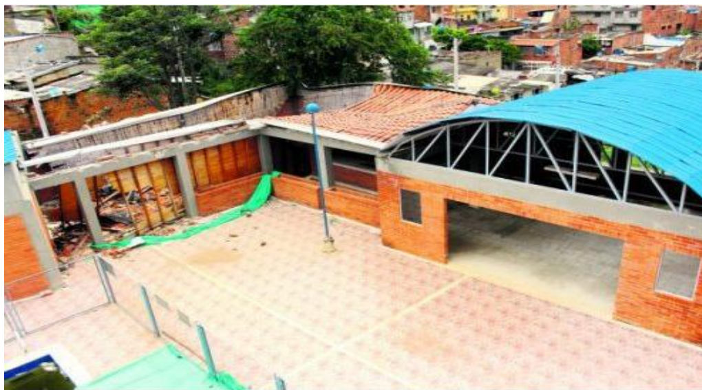
Figura 10. Desplome del muro y fallo estructural del Centro Cultural La Cumbre. Fuente: Vanguardia Liberal.
