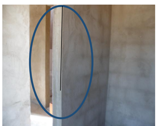
Foto 28. Solución para columna deforme
