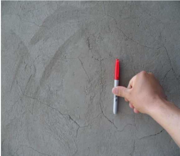
Foto n.26. Fisuración en el pañete.
