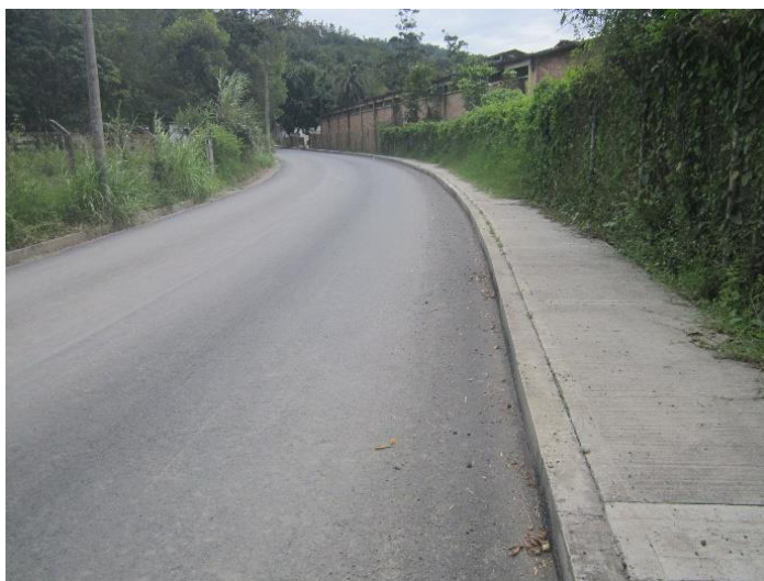
Imagen 23. Falta limpieza y corte de hierba
