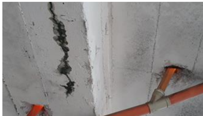
Figura 24. Conexiones Mal Hechas y Filtraciones. Fuente: elaboración propia
