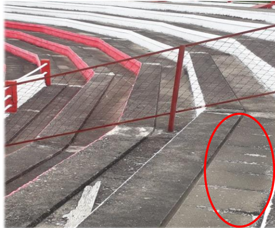
Figura 6. Lesiones de Fisuras en las Gradas. Fuente: elaboración propia
