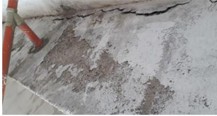
Figura 11. Fisuras en vigas. Fuente: elaboración propia
