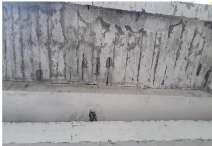
Figura 10. Humedad Zona Externa Graderías, Voladizo. Fuente: elaboración propia
