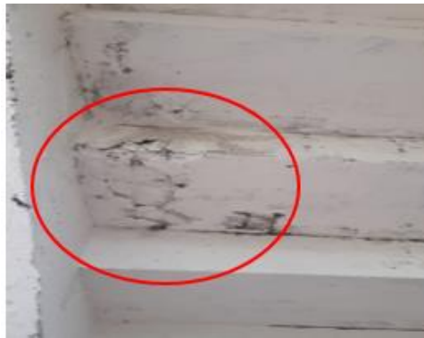
Figura 8. Desprendimiento de Material Zona Externa Gradería. Fuente: elaboración propia
