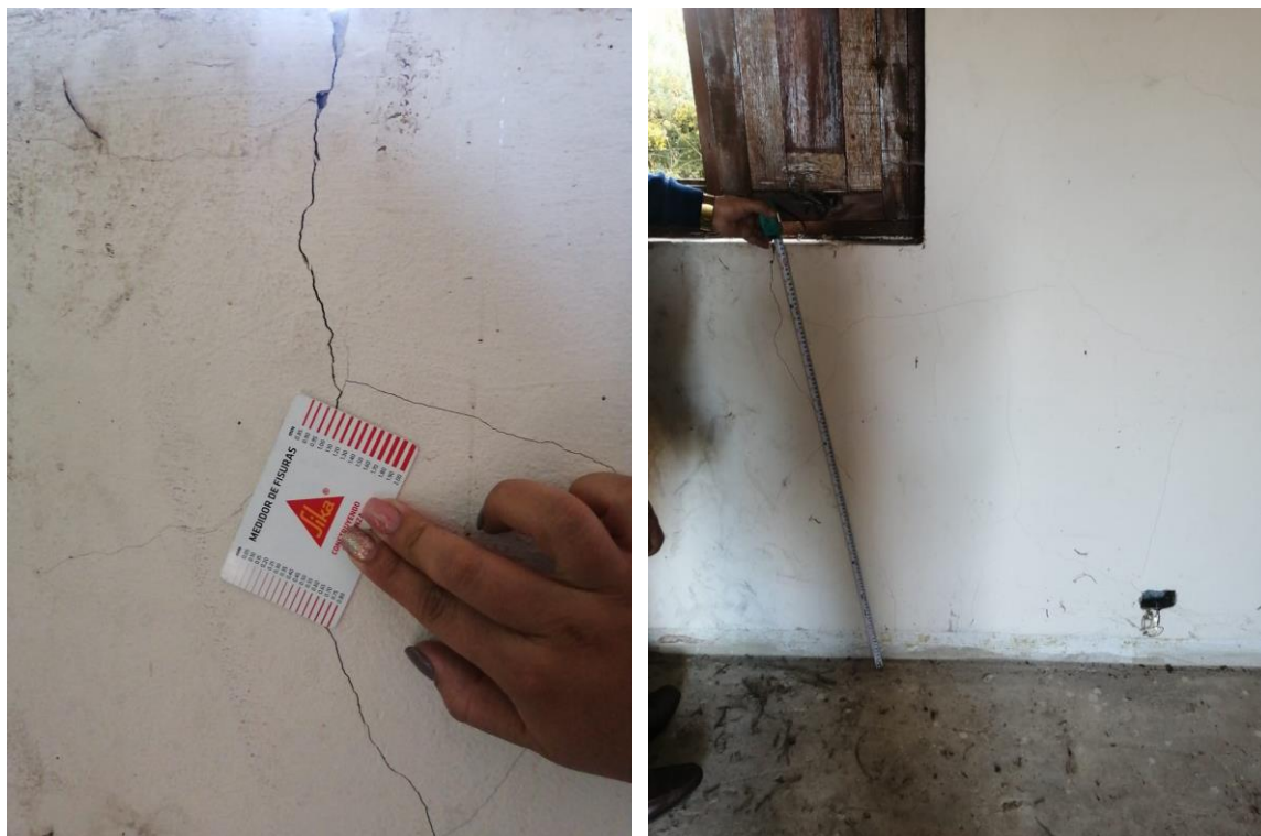
Fisuras por asentamientos diferenciales
