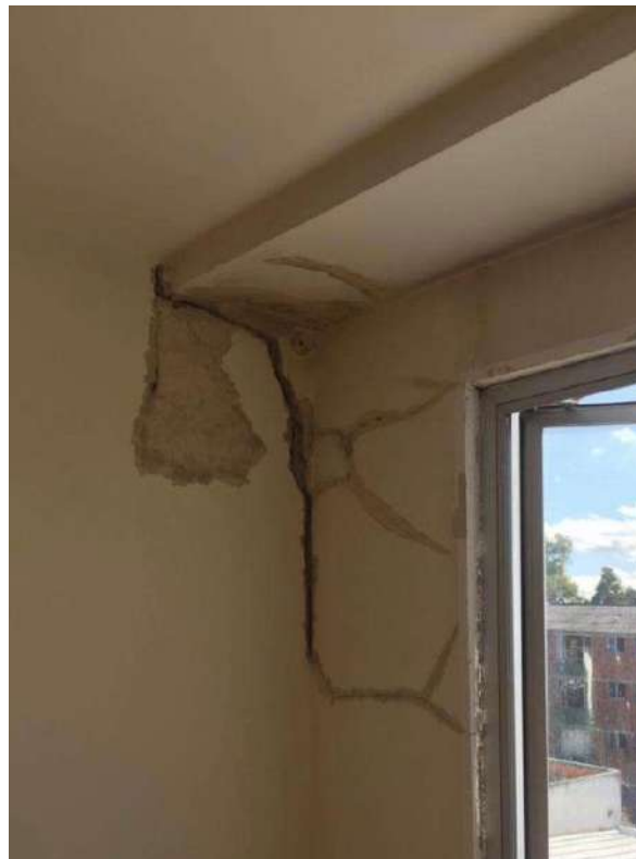
Figura 7. Grietas en muros.
