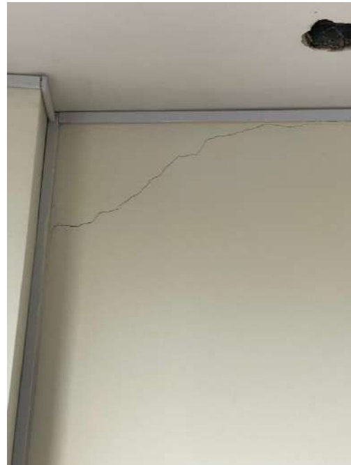
Figura 13. Fisuras en muros.
