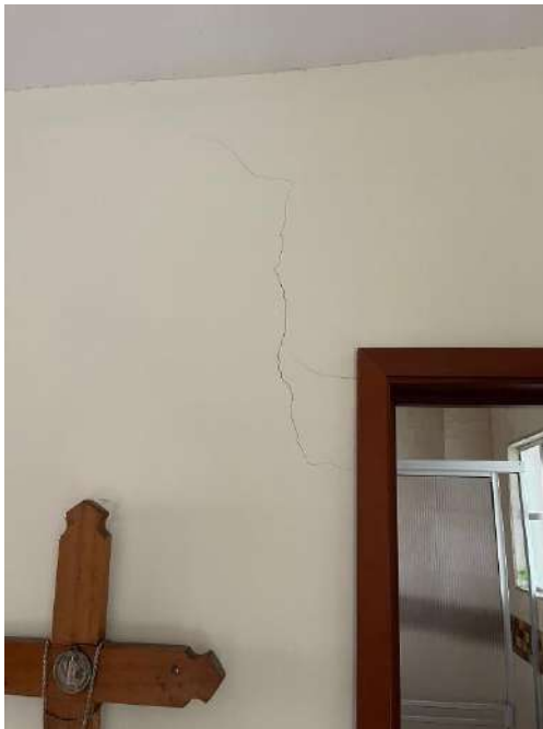
Figura 12. Fisuras en muros.
