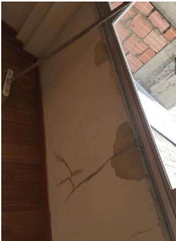
Figura 6. Fisuras en muros.
