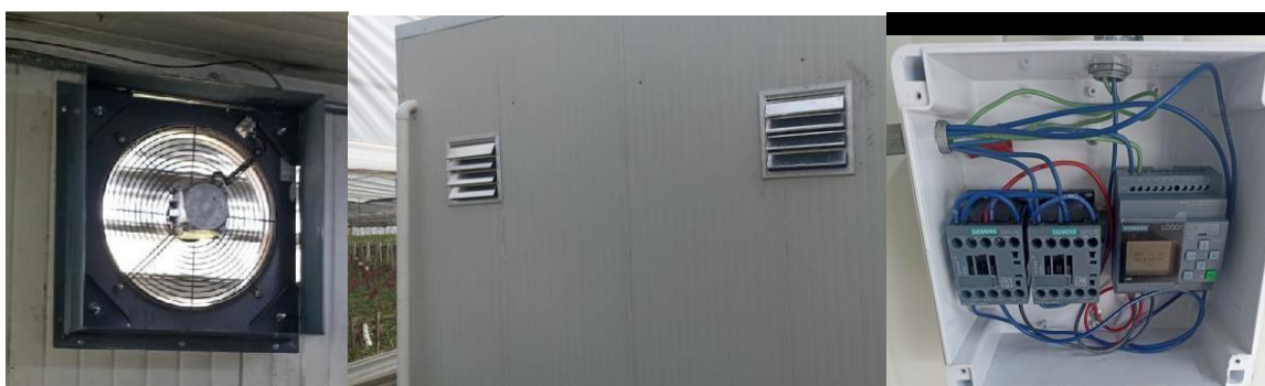
Figura 4. Imagen de los extractores instalados y el sistema de control existente
