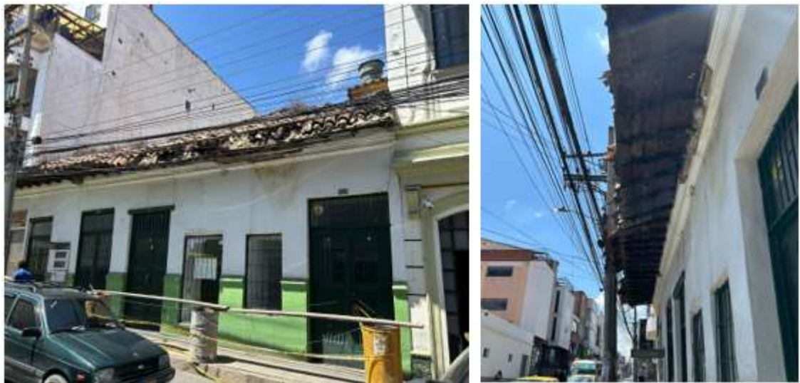
Ilustración 3 Visita de verificación de vivienda por caída de tejado
