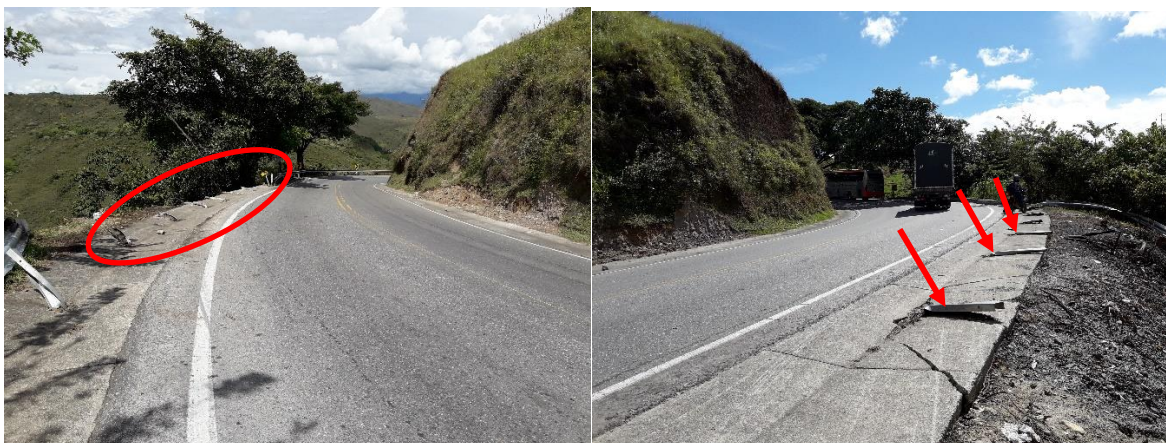
Figura 27 Estado de la barrera metálica después de accidente - Ruta 2503 (PR 54+400 a PR 54+750)
