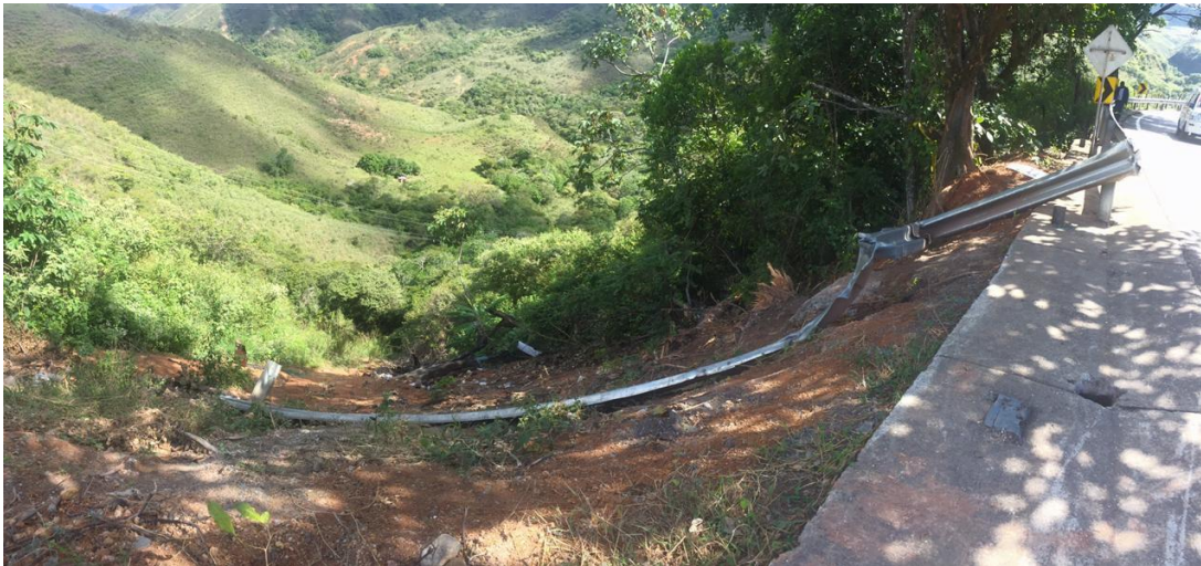
Figura 29 Estado de la barrera metálica después de accidente - Ruta 2503 (PR 54+400 a PR 54+750)
