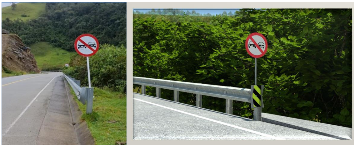
Figura 54 Cambio de terminal tipo “cola de pez” por terminal absorbente al inicio del tramo
