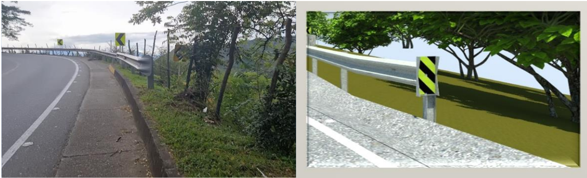
Figura 36 Cambio de terminal tipo “cola de pez” por terminal absorbente al inicio del tramo
