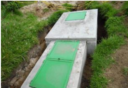
Figura 24. Fotografía Cámara de quiebre ubicada en la cota k6+660 hasta k0+957 conducción principal y ramal 4
