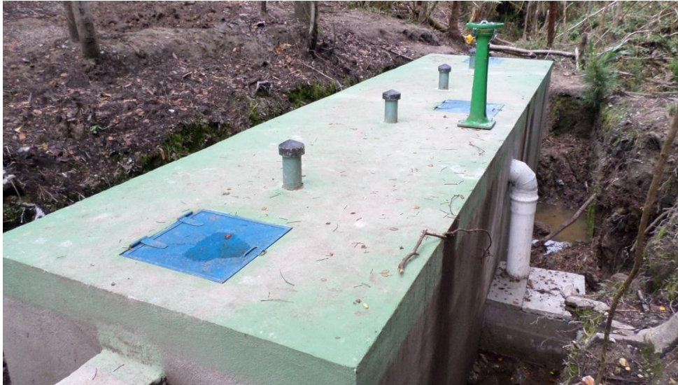
Figura 17. Fotografía del Desarenador en funcionamiento cota de ubicación k0+015
