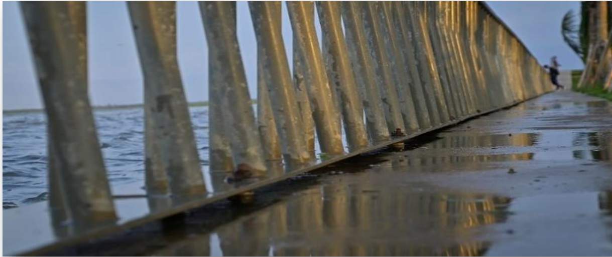
Figura 8. Desagüe aguas lluvias por pendiente Gran Malecón de Barranquilla
