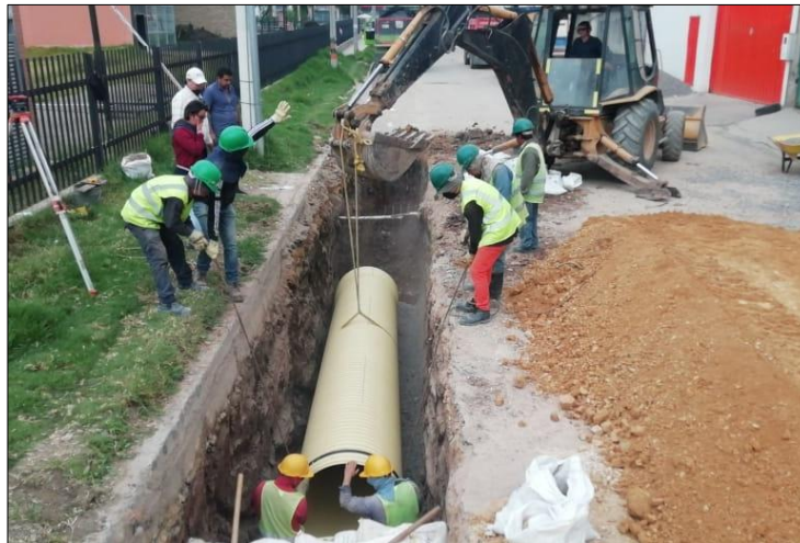
Imagen 24. Finalización instalación alcantarillado pluvial de 36" (pulgadas) en la calle 10 con avenida circunvalar
