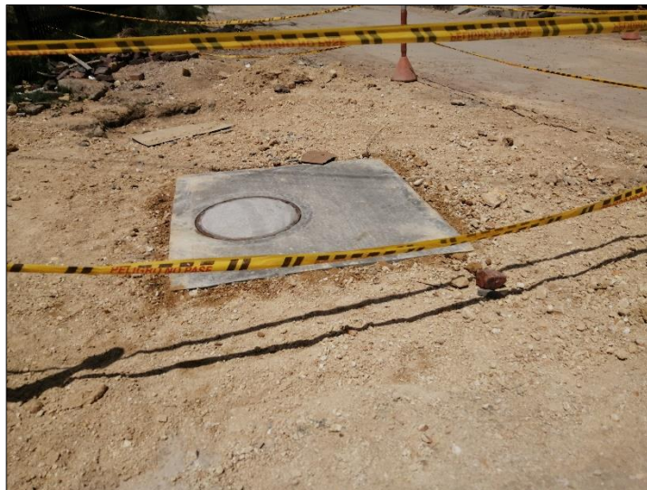
Imagen 35. Pozo de inspección final
