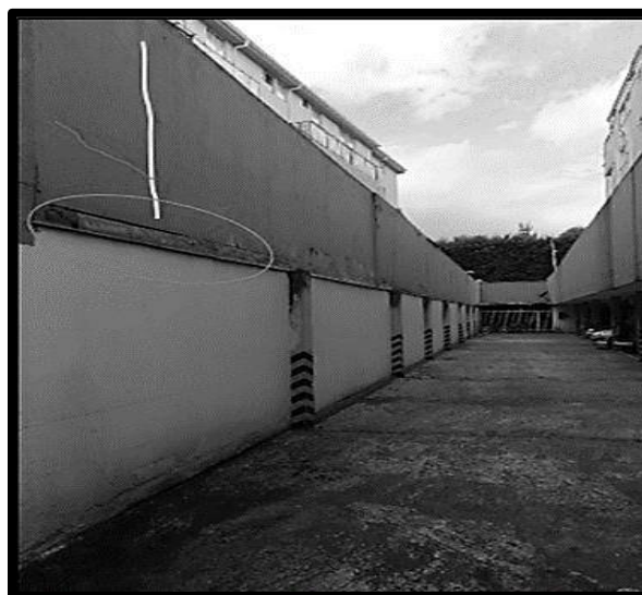
Figura 7. Muro perimetral patios aptos primer piso. Tomada por los integrantes de la investigación
