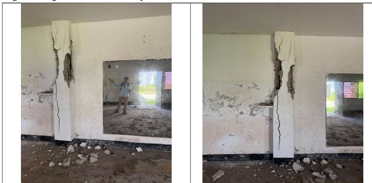
Imagen 1 y 2 Lesiones severas columnas piso 1 sector sur
