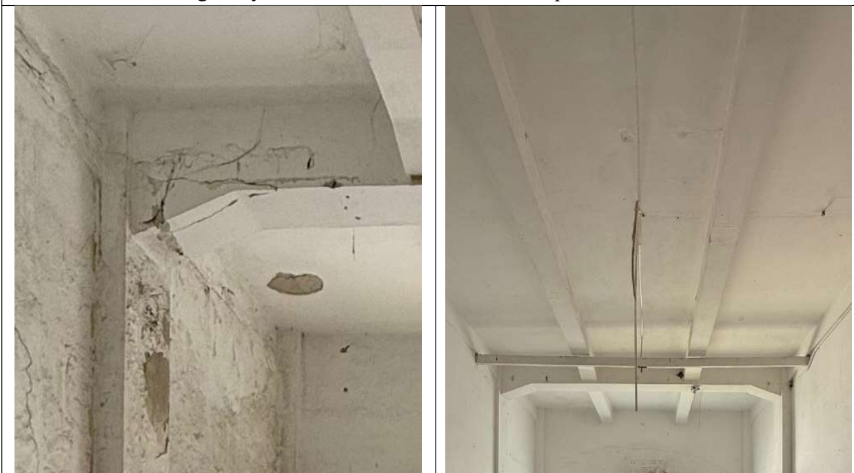
Imagen 5 y 6 Lesiones en vigas y losa del sector occidental.
