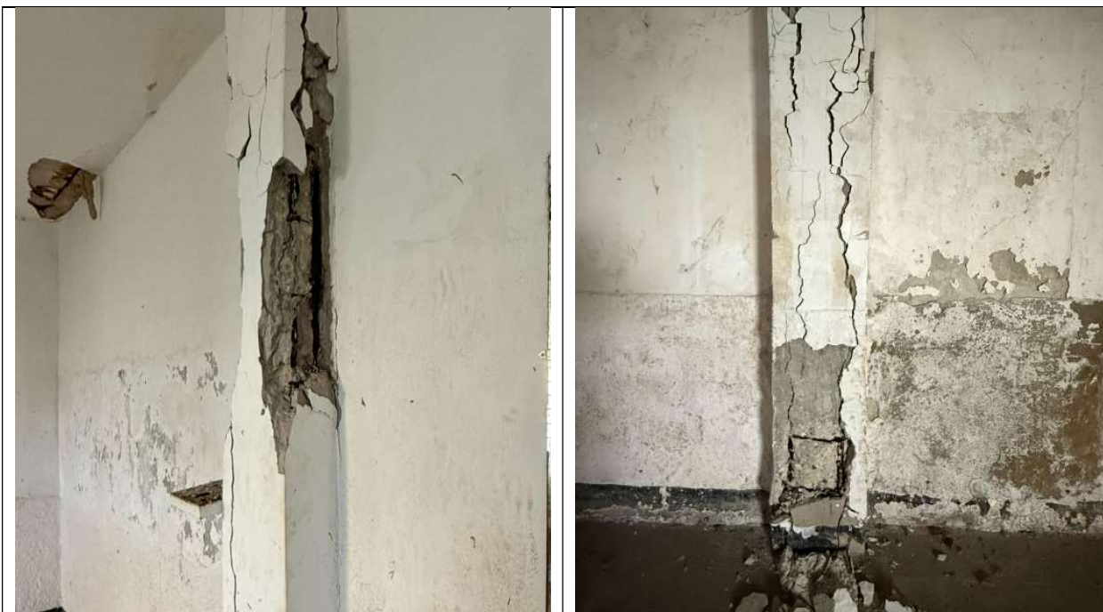
Imagen 3 y 4 Lesiones severas en columnas piso 1 sector sur.
