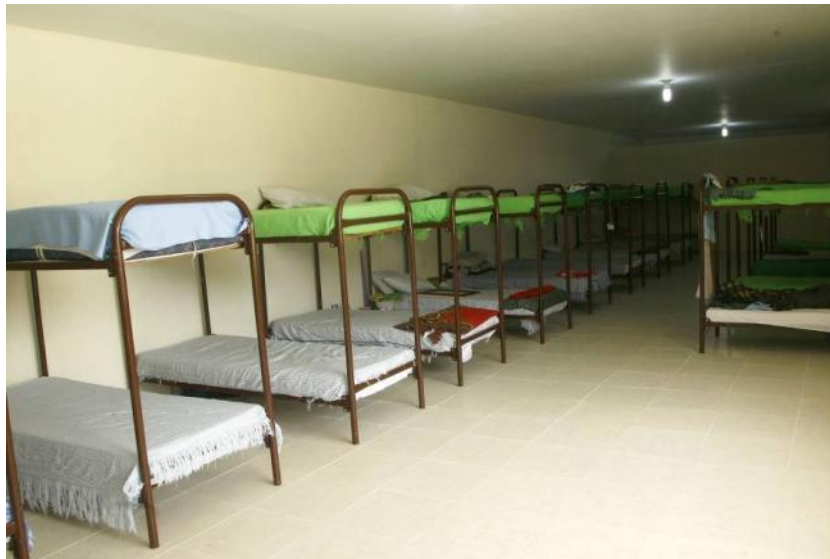
Figura 33. Avance en el mejoramiento de algunos dormitorios de la Casa de Menores (CASAM) de Hogares Claret el techo aun presenta deterioros, año 2013. Recuperado de “Mejorarán las condiciones físicas de Hogares Claret” Vanguardia Liberal , Pineda, L. C. (30 de junio de 2013).
