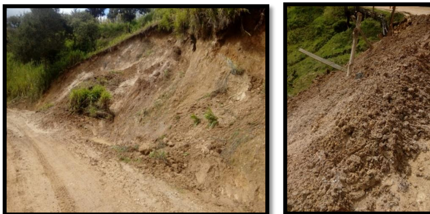
Fotografía 9.Deslizamiento Talud Carretera vereda Chiguata
