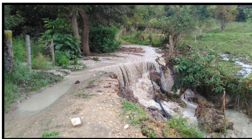
Fotografía 8. Deslizamiento de vía por taponamiento de Tubería
