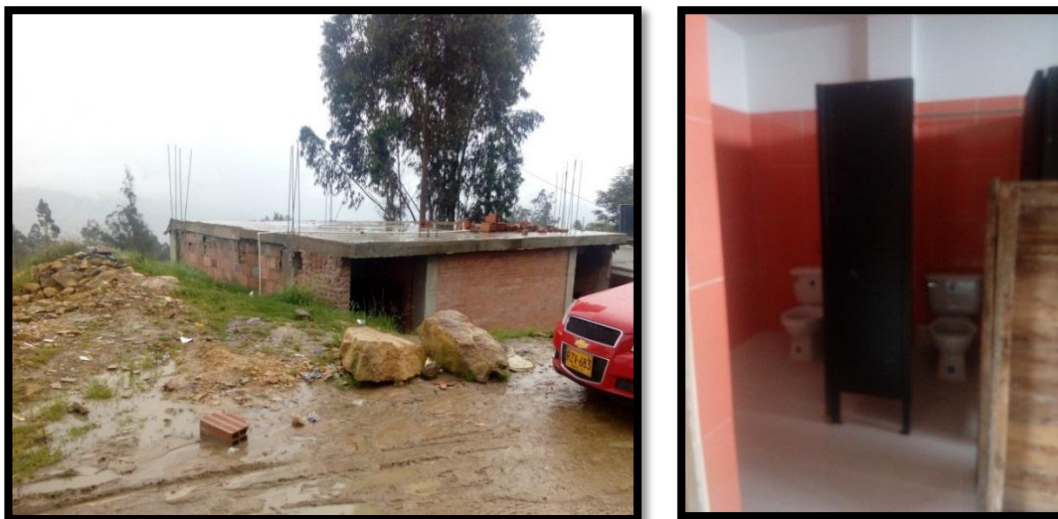
Fotografía 18.Unidad Sanitaria Colegio Supaneca.
