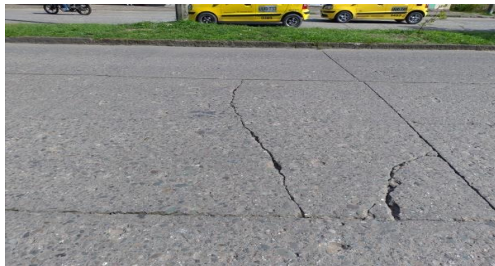
Ilustración 3. Grieta en Esquina
