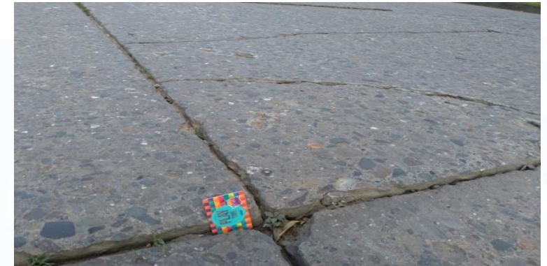
Ilustración 8. Daños de Sellos
