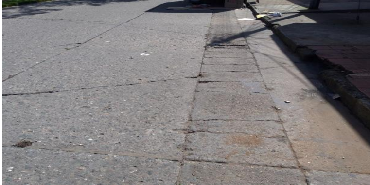
Ilustración 5. Parche en Concreto
