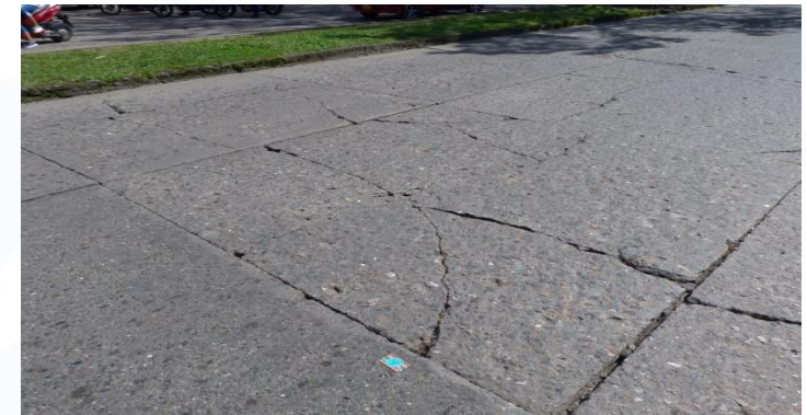
Ilustración 4. Grieta en Bloque
