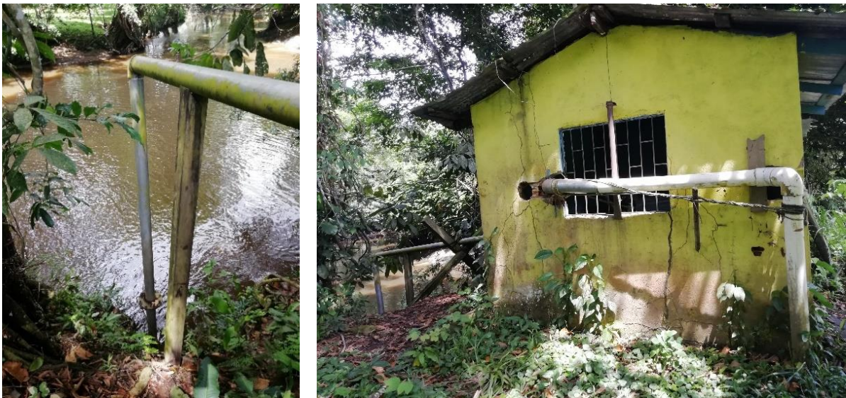
Figura N° 13 Sistema de bombeo implementado para llevar el agua a los hogares
